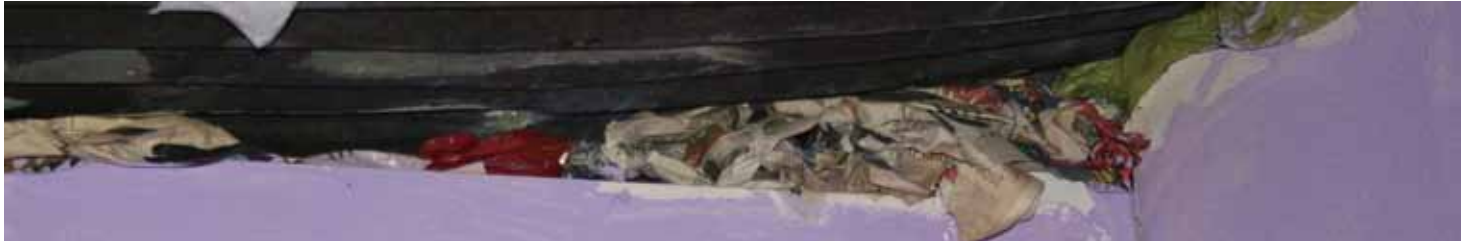
Dämmung der Fugen durch alte Zeitungen und Plastiksäcke
