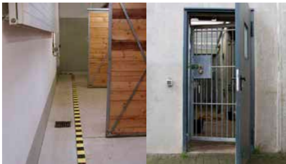
Abb. 107 Ablaufrinne mit farbiger Markierung. Abb. 108 Durch Gittertür (äußere Schleusentür) gut einsehbare Schleuse (Bediengang) - zweite Tür aus klimatischen Gründen.
