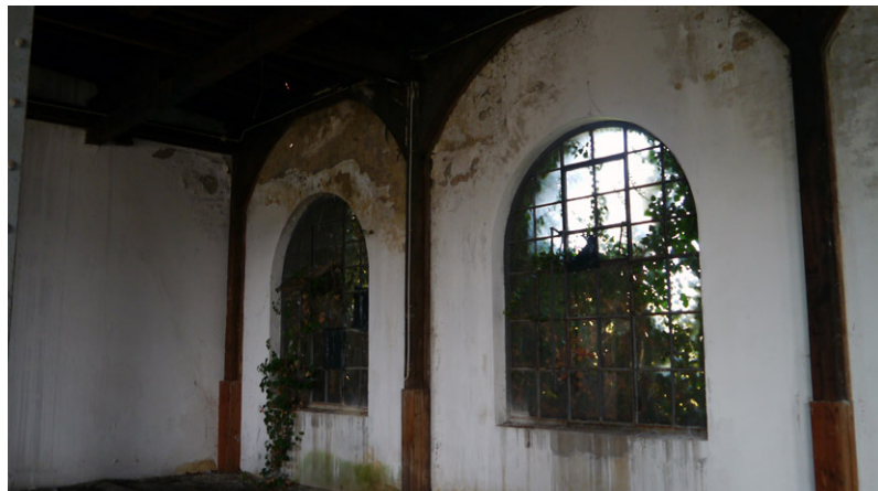
31 beschädigter Fensterbestand im dritten Obergeschoss des Mehlspeichers (A1)
