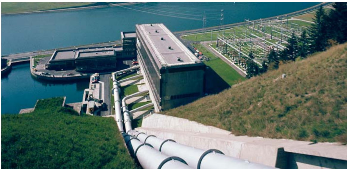
Abbildung 2.10: Hangrohrleitung des Pumpspeicherkraftwerkes Malta Hauptstufe (Verbund, 2012)
