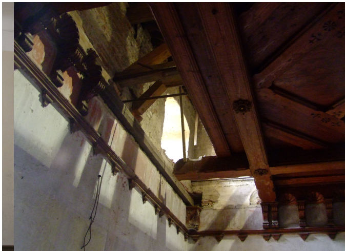
Die teilweise eingestürzte Decke im Osttrakt.
