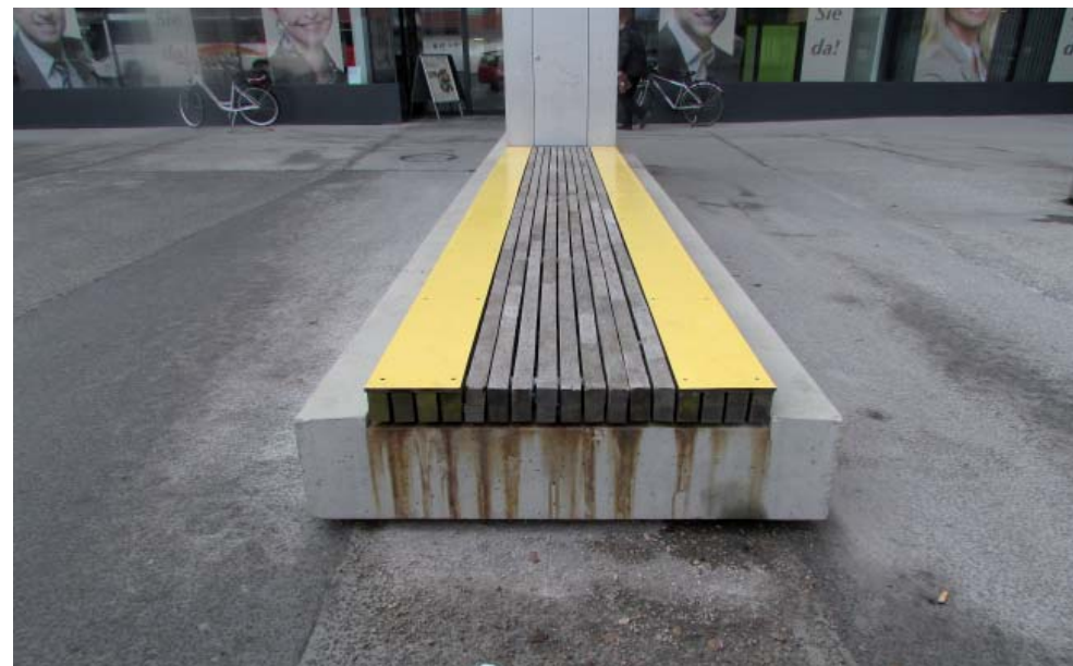
Abb.18: Erste Baumängel sind bereits sichtbar
