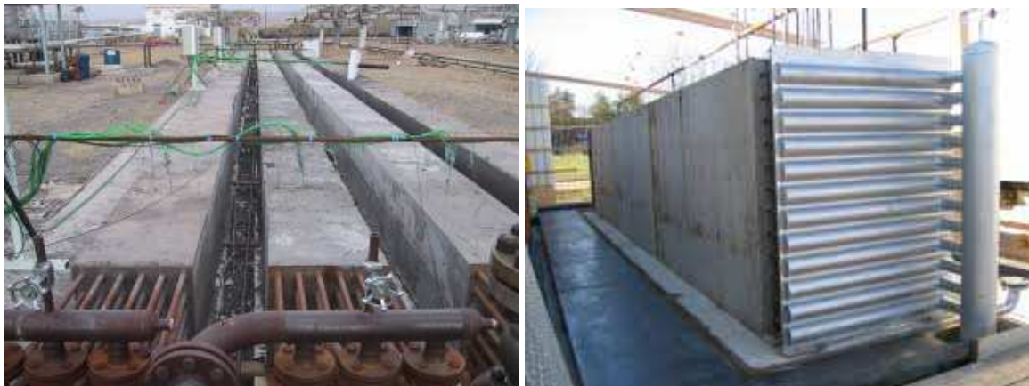
Abbildung 6.5 links Beton Feststoffspeicher in Almeria, rechts Restmodul am Gelände der UNI Stuttgart [6.5]
