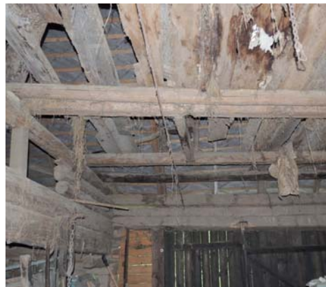
oben links: Dachhse aus Blech oben rechts: Sparrenauflager, gemorschte Balkenköpfe mitte: Schäden an der Dachhaut unten links u. rechts: durchgemorschter Bretterboden
