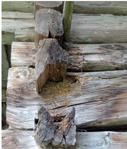
oben links: abgenutzte Bodenschwelle oben rechts: Stallboden mitte links: beschädigter Steinsockel mitte rechts: Schimmelbefallenes Steinmauerwerk, erdberührt unten links: beschädigte Holzwand und beschädigtes Steinmauerwerk unten rechts: verfaulte Balkenköpfe
