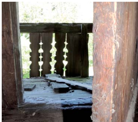
oben links: morschte Fenstereinfassung oben rechts: beschä- digte Außentreppe Stein mitte links: Holzterre mitte rechts: Ka- chelofen große Stube, gekaltte Wände unten links: Ofen der hinteren Kammer unten rechts: beschä- digter Balkon
