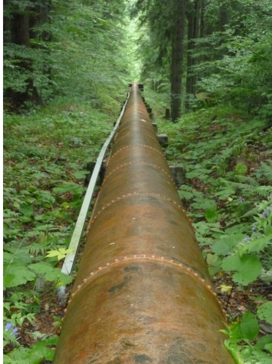
Abbildung 4.7: Druckrohrleitung KW I [Quelle: Eigene Aufnahme]
