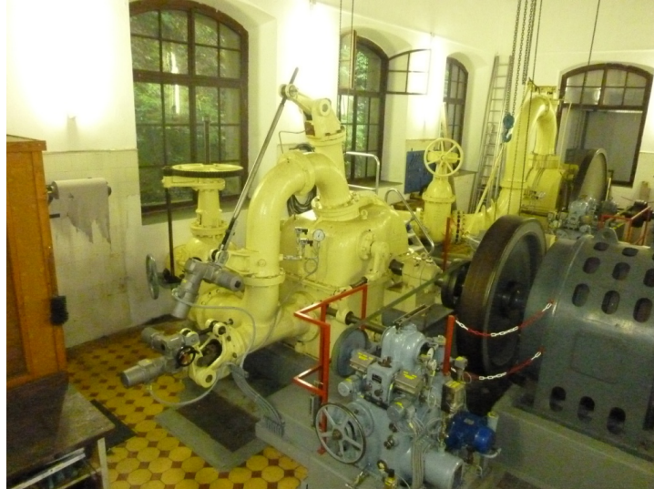
Abbildung 4.9: Maschinensatz Kraftwerk I [Quelle: Eigene Aufnahme]
