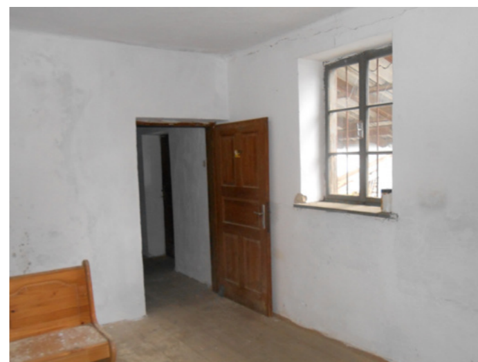
Abb. 24: Risse im Bereich der Decke
