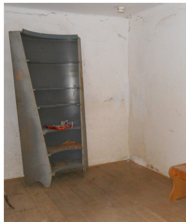
Abb. 23: Rissbildung in den Raumkanten
