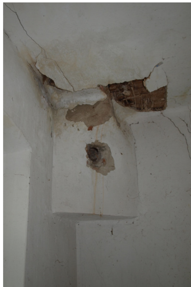
Abb. 63: Schäden durch Eindringen von Wasser
