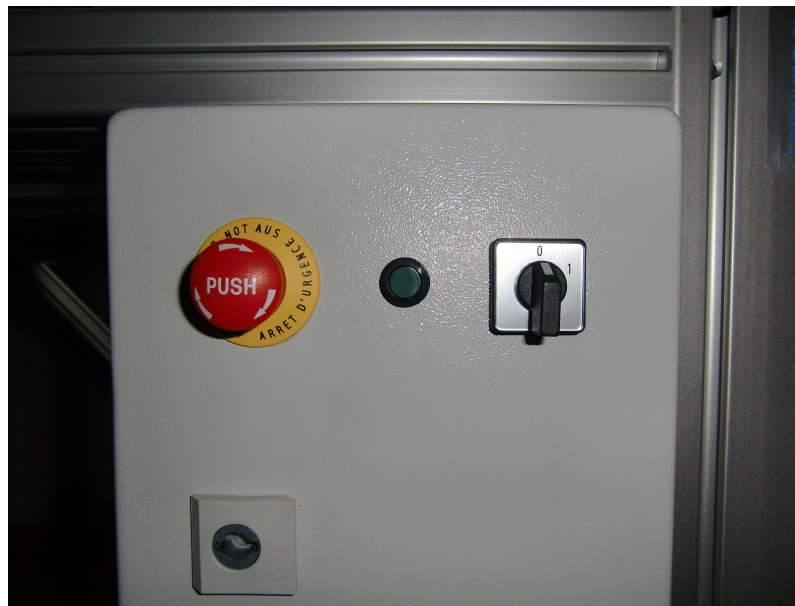
Abbildung 3.25.: Schaltschrank mit Notausschalter, zentralem Ein-/Aus-Schalter und Signallampe
