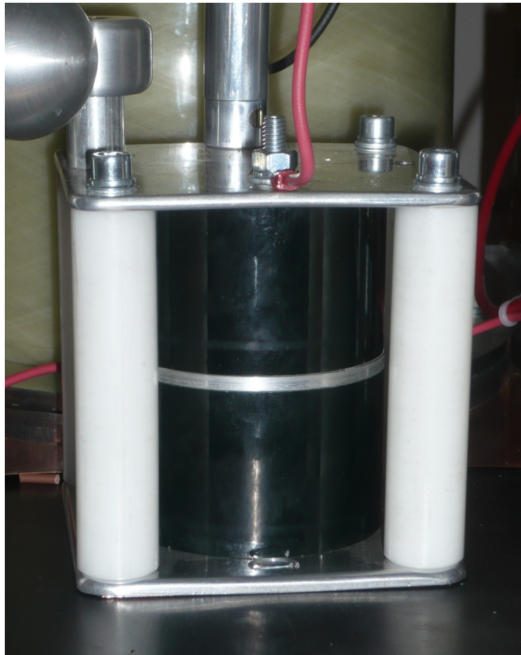
Abbildung 93: Überladeschutz bestehend aus zwei Varistoren
