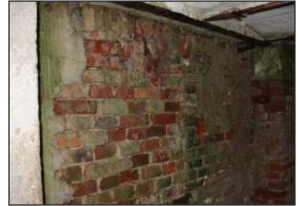
Abb. 59 Ziegelmauer nass und veralgt
