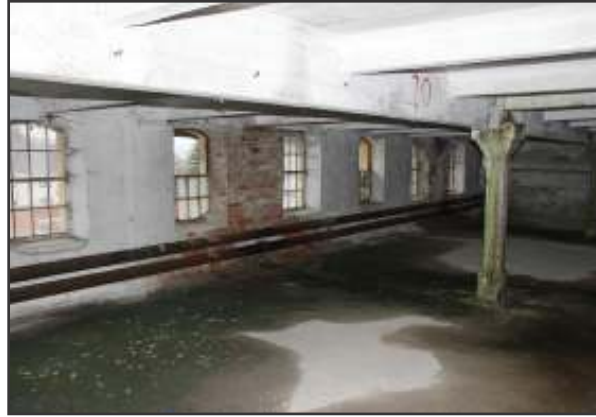
Abb. 66 Nässestellen im inneren Bereich
