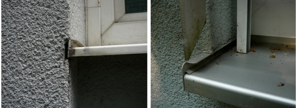
Abbildung 98: Unzureichender seitlicher Außenfensterbankanschluss 01 (Praxisbeispiel)
