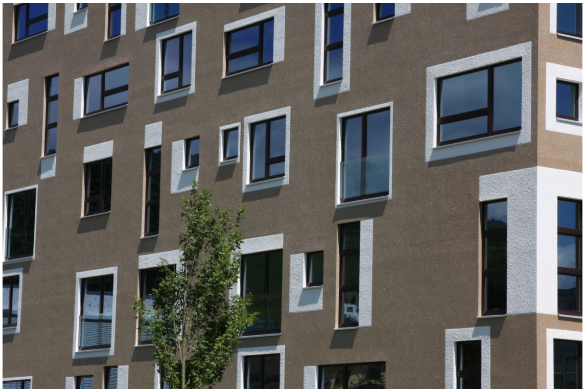
Abbildung 103: Beispiel für schlecht versetzte Außenfensterbänke (siehe Schlagschatten)
