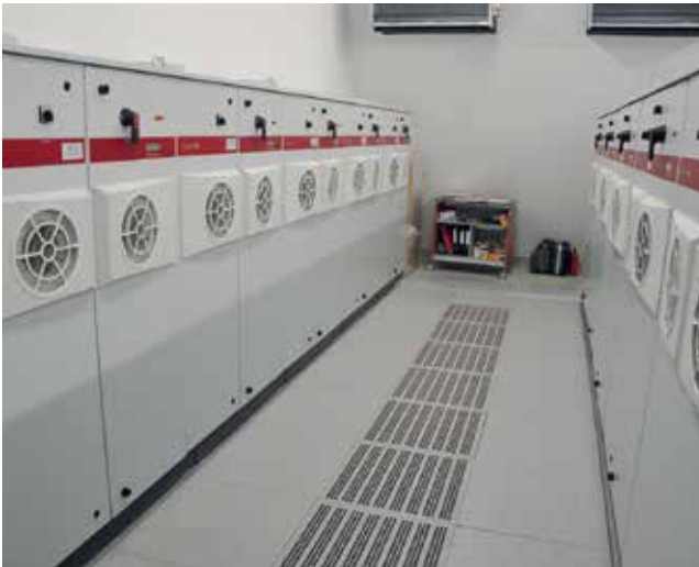
Abb. 6.191 Wechselrichter einer Großanlage
