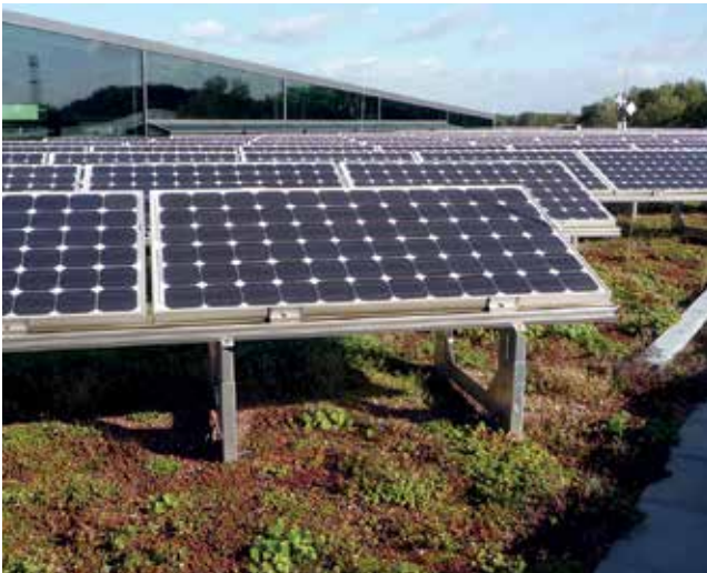
Abb. 6.148 Photovoltaikanlage auf Flachdach
