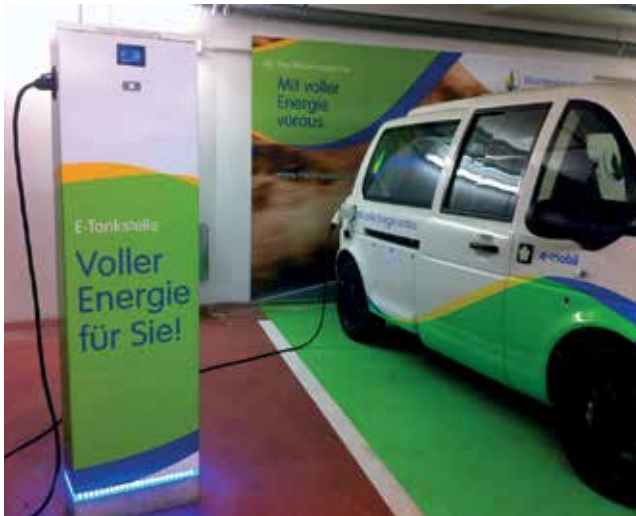
Abb. 6.79 Tankstelle für Elektro-Fahrzeuge
