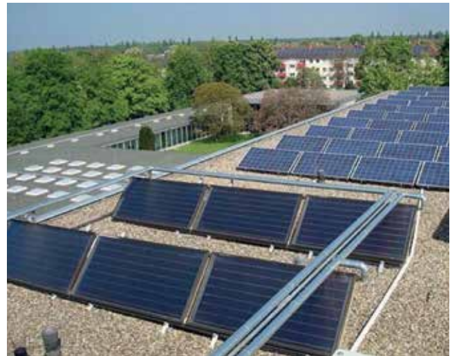
Abb. 6.183 Thermische Solaranlage, Photovoltaik
