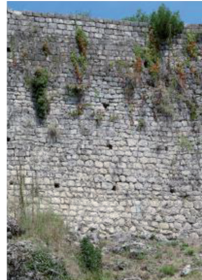
Abb. 57: Lochebene an der Mauer
