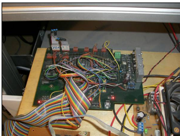
Abb. 35: Foto der Steuerungsplatine
