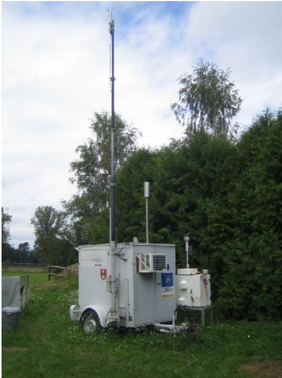
Abbildung 45: Messcontainer der Hintergrundmessstation
