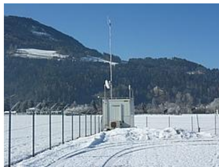
Abbildung 62: Messstation Tiefbrunnen Ansicht von Norden (48)
