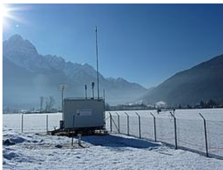
Abbildung 61: Messstation Tiefbrunnen Ansicht von Westen (48)
