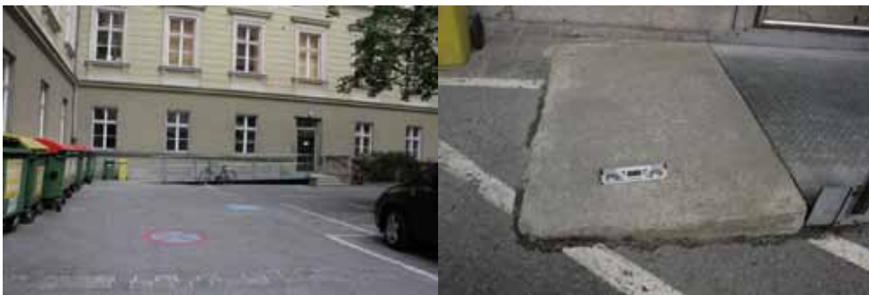
Bild 62: Die „offizielle“ Rampe für Menschen mit Behinderungen beginnt mit einem Betonkeil mit 13,9% Gefälle (erlaubt wären 6%)
