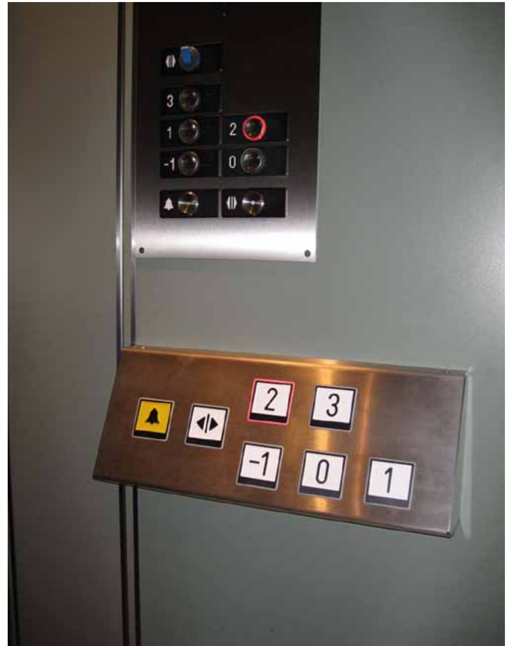
Bild 40: Horizontales Bedientableau in einem Lift mit taktiler Reliefbeschriftung der Tasten
