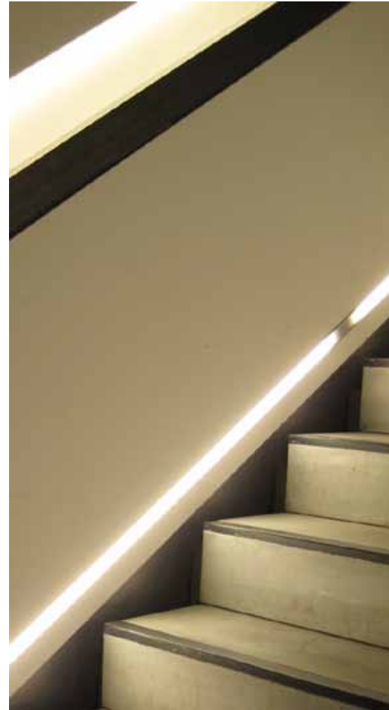
Bild 14: Am Bild erkenntlich: Beim Handlauf ist eine indirekte Beleuchtung, welche blendfrei ist, darunter eine direkte, blendende Beleuchtung – falsch.
