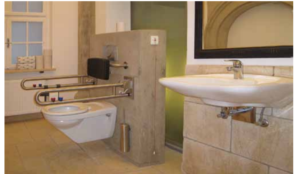
Bild 35: Universell anfahrbares WC (Landhaus, Herrengasse) mit Design-Elementen
