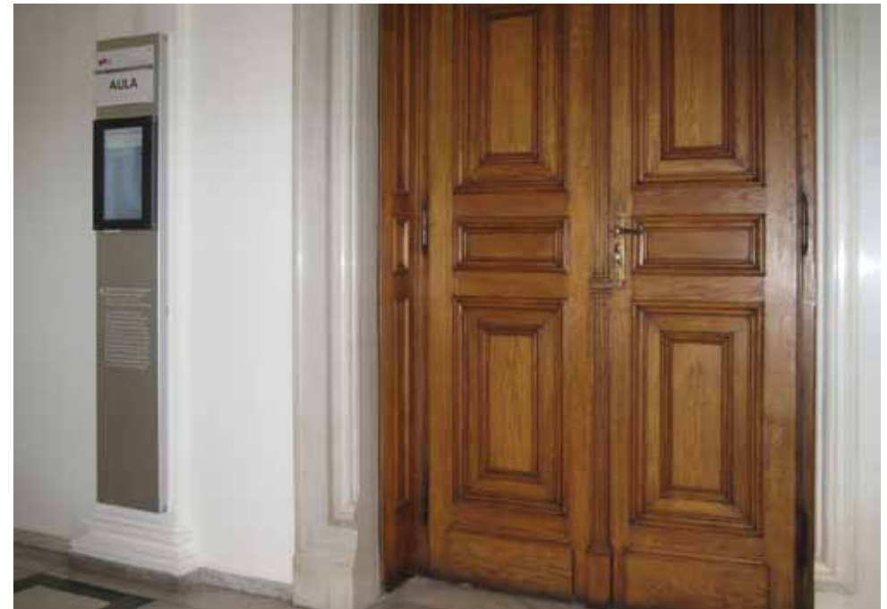
Bild 104: Derzeit bestehende Beschriftung der einzelnen Räume mit einem Bildschirm
