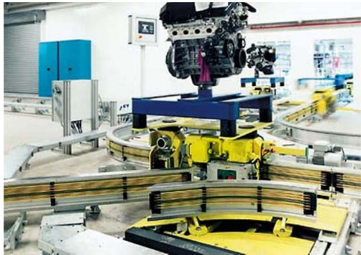
Abbildung 4.6: ETB in einem Motorenwerk [AFT- Group, 2004]
