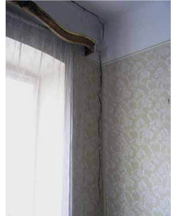
Abb.45 Risse in den Anschlussbereichen Wand und Decke
