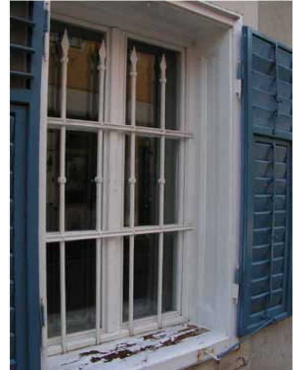
Abb.64 Feuchteschaden am Fenster
