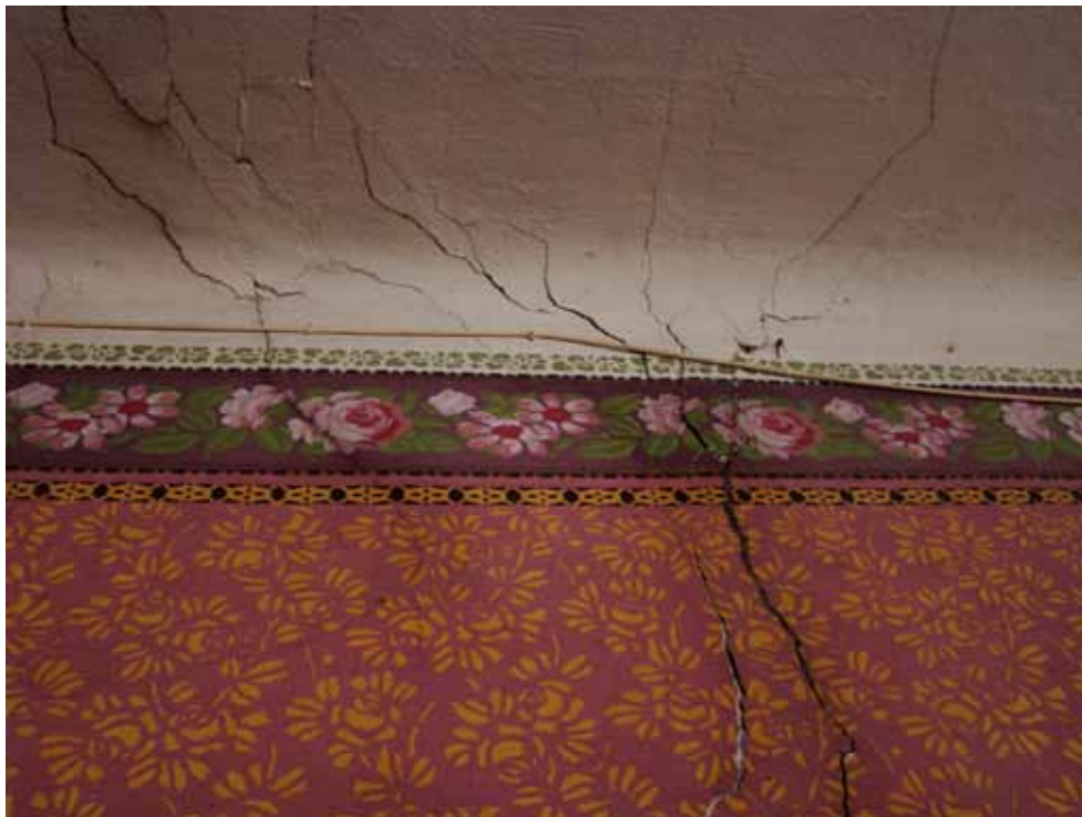
Abb.63 Risse in der Wand auf Grund von statischen Mängeln
