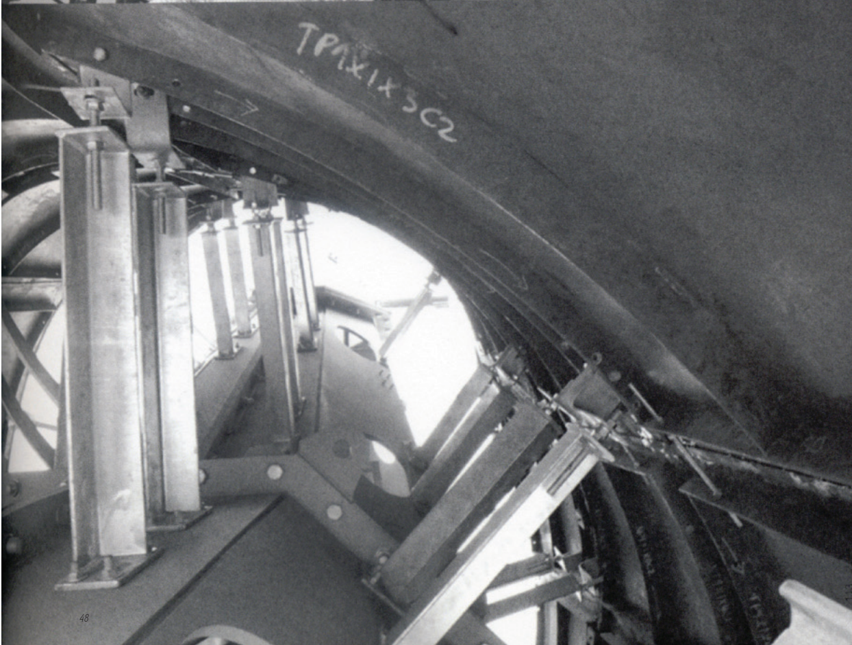
Abbildung 49: Tragkonstruktion des Bahnhofs in Florenz von Arata Isozaki. Im Inneren befindet sich der sechseckige tragende Kern, auf dem Abstandshalterungen zur Befestigung der finalen Freiformoberfläche montiert sind.
