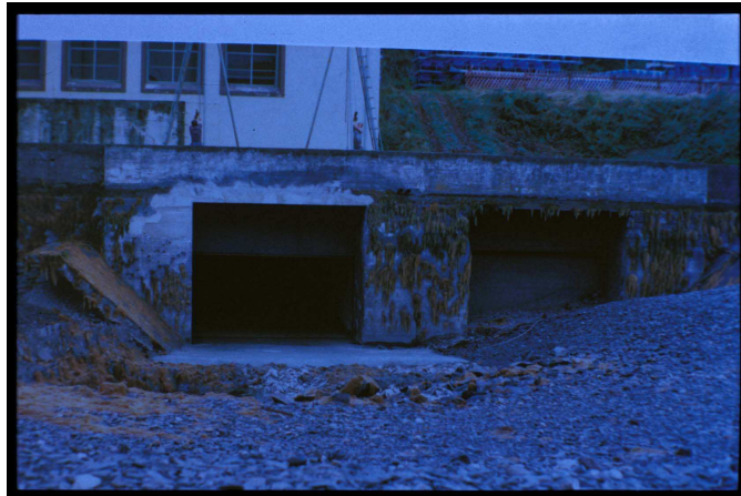
Abbildung 6. Foto der Saugrohröffnungen [Archiv WVER 2010]
