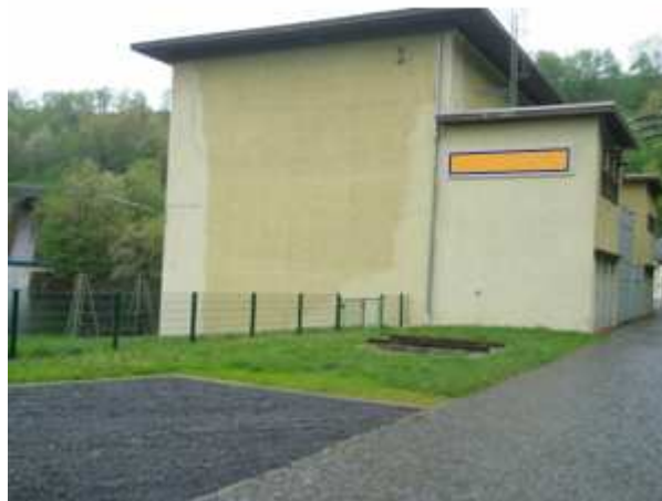
Abbildung 32. Durchbruchmöglichkeit zur Netzanbindung [Eigene Aufnahme 2010]
