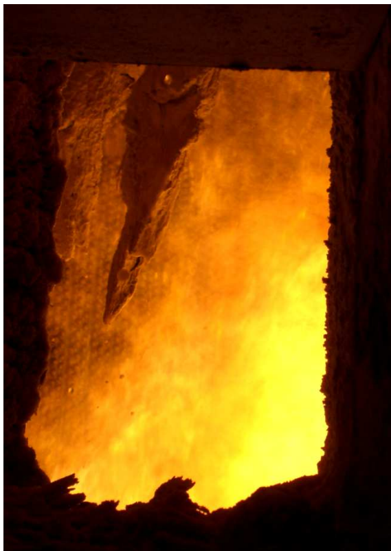
Abbildung B-6-1: Brennkammer Fouling während des Ausheizens durch Erdgasflamme
