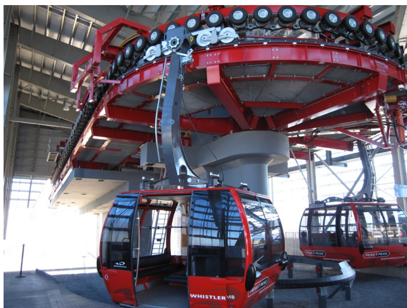
Abbildung 2-5: Stationstraggerüst mit 3S-Fahrzeugen [Lit. 22]
