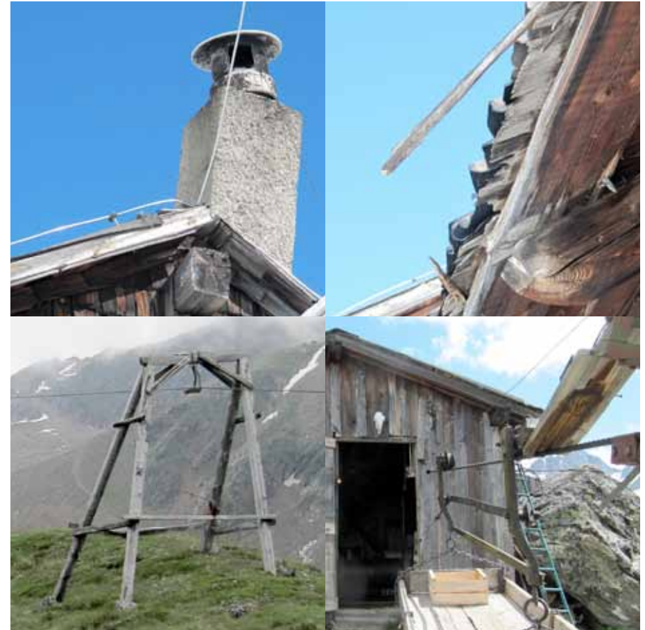
Der schlechte bauliche Zustand der Weißkugelhütte und der Materialseilbahn
