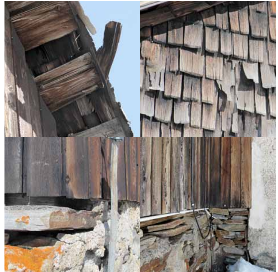
Der schlechte bauliche Zustand der Weißkugelhütte
