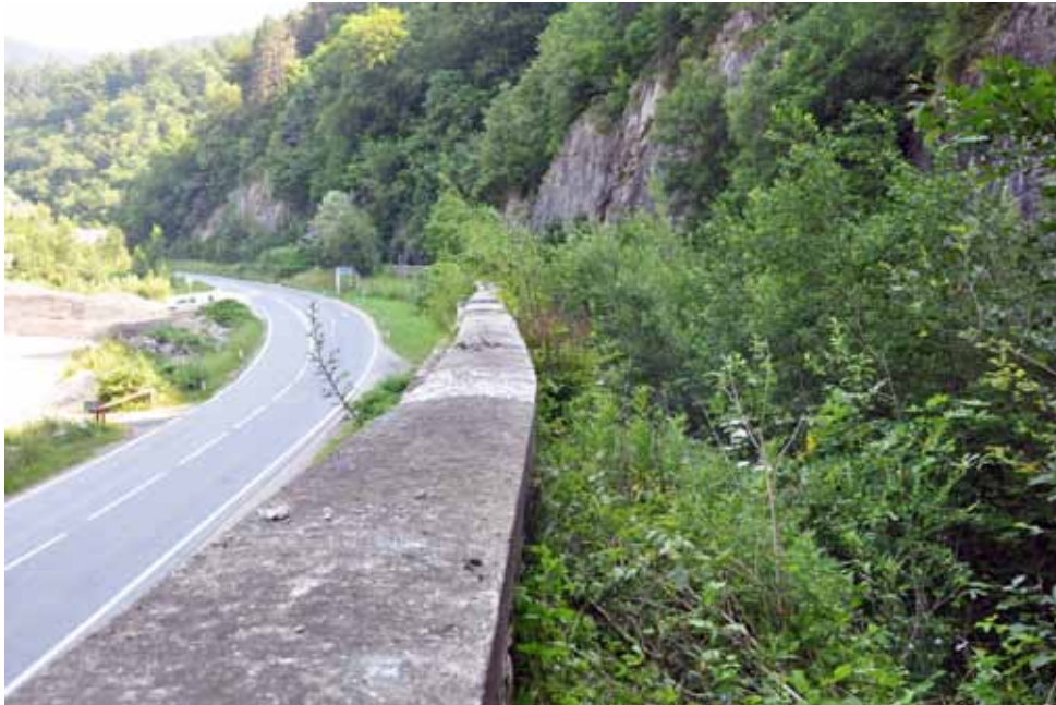
Abb. 139: Blickrichtung Nord, gut zu erkennen die Lageverschiebung der Aufmauerung (Absturzsicherung) durch desolante Gewölbebereiche; 07/2010
