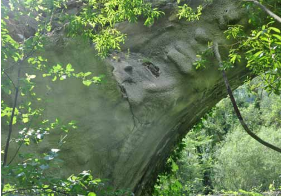
Abb. 153: Rissbildung bzw. biogener Bewuchs des 2000 aufgetragenen Spritzbetons; 07/2010
