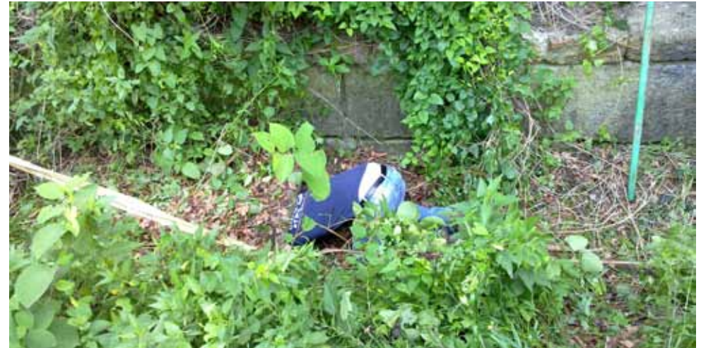
Abb. 135: Befundung der Revisionschächte zwischen Brucker Bundesstraße und der Galerie, 07/2010
