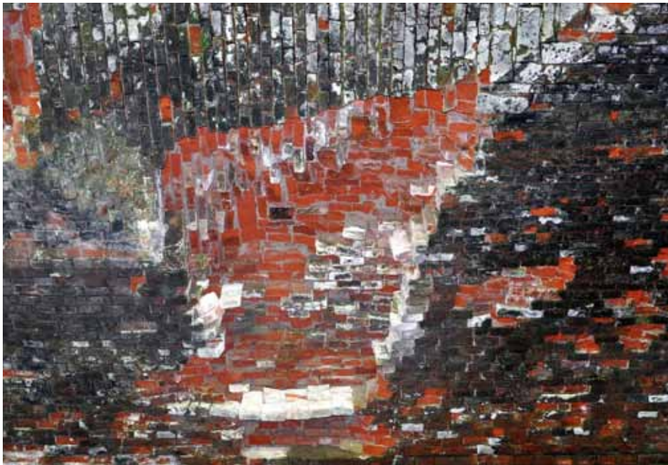
Abb. 145: Ausbruchstellen, hervorgerufen durch Dauerfeuchte in der Gewölbekonstruktion sowie der diffusionshemmenden Rußschicht; 07/2010
