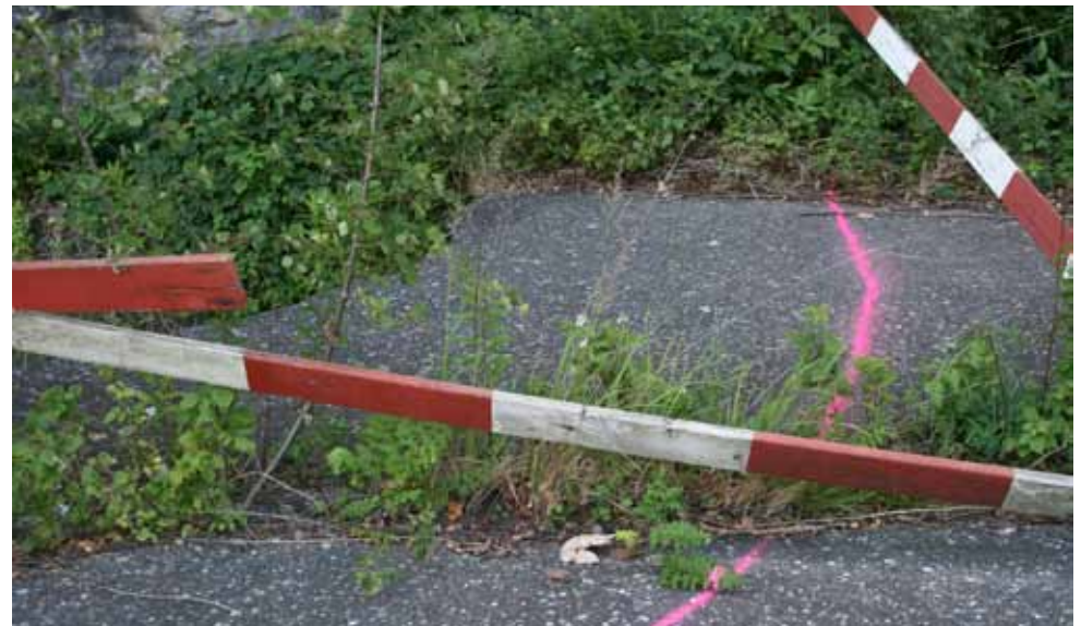
Abb. 133: Schlecht gewartete Absturzsicherungen
