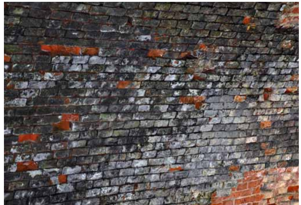
Abb. 144: Detail des Tonnengewölbes mit der schädigenden Ruß- bzw. Sinterschicht; 07/210
