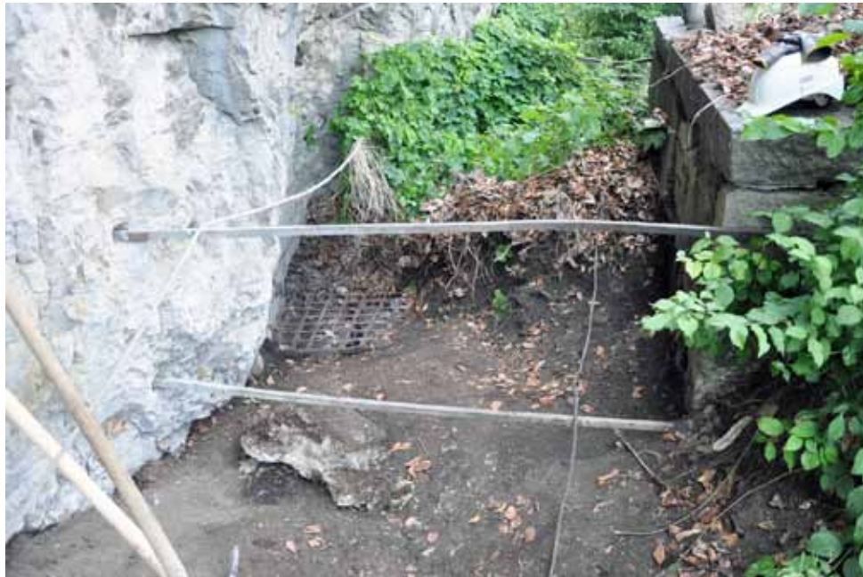
Abb. 137: Abfluß zwischen Pfeiler 8 und 9, gut zu sehen die etwa 70cm starke Humusschicht sowie das stark oxydierte Kanalgitter; 07/201
