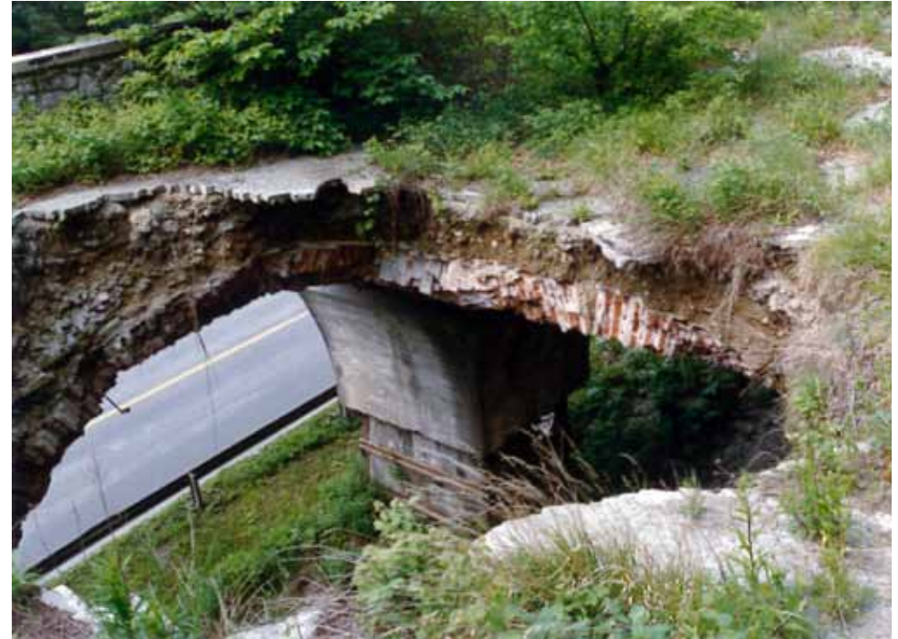
Abb. 150: 1989/1990 eingestürzter Bereich zwischen Pfeiler 34 und 36; 1990
