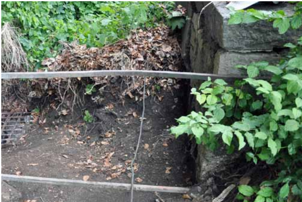
Abb. 14.2: Verformte Absturzsicherungen aus Eisen, sowie Lageverschiebung der Steinmauer, vermutlich durch KFZ- Aufprall; 07/2010
