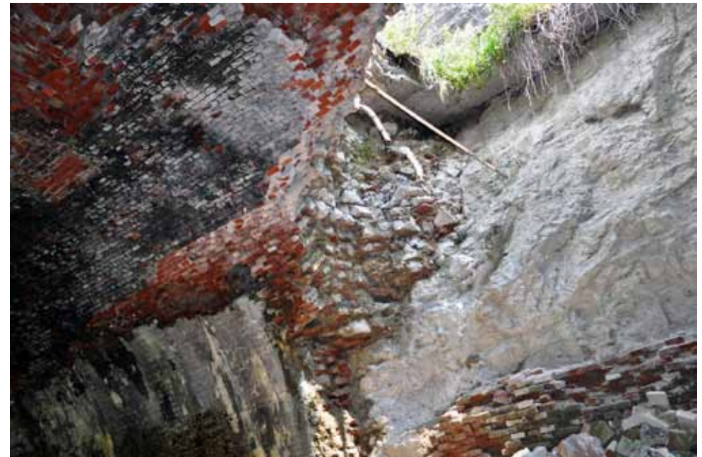
Abb. 140: Durch Dauerfeuchte hervorgerufenes Versagen der Gewölbe konstruktion im Zwickelbereich; 07/2010
