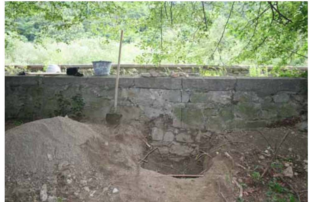
Abb. 138: Völlig mit Geröll und Humus verschlossener Wasserabfluss zwischen Pfeiler 27 und 28; 07/2010
