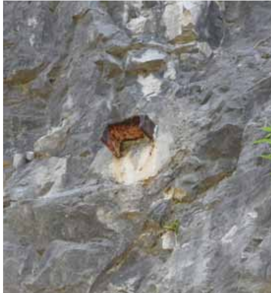
Abb. 189: Befestigungspunkte des ehem. Steinschlagschutzes; 06/2011
