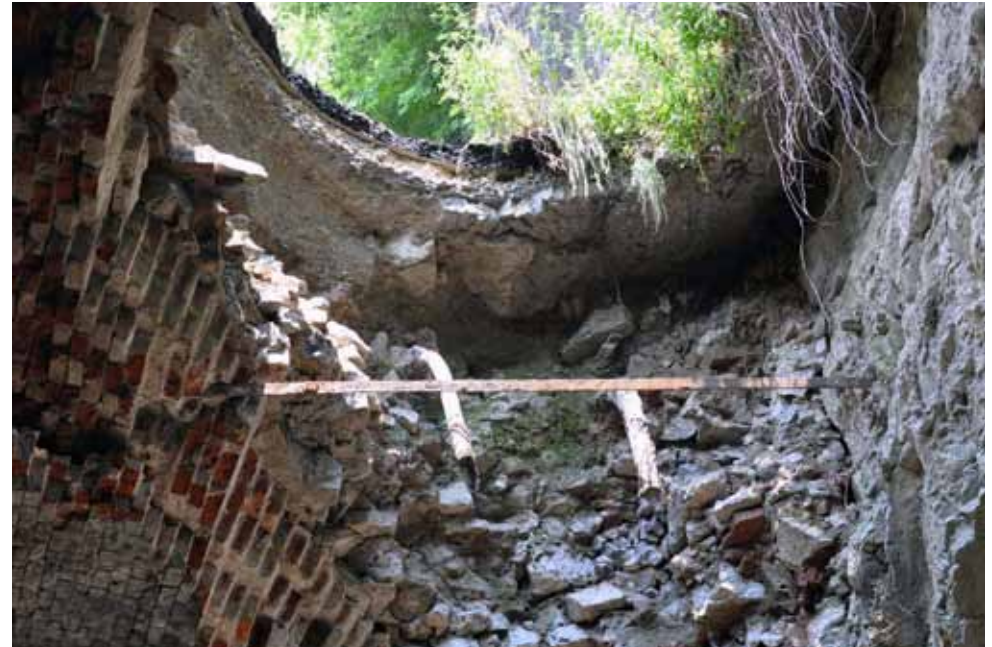
Abb. 117: Gewölbeanker im Anschlußbereich zur Felswand; 07/2010
