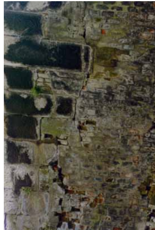
Abb. 147: Risse zwischen Stein- und Ziegelmauerwerk im Nordportal; 1990
