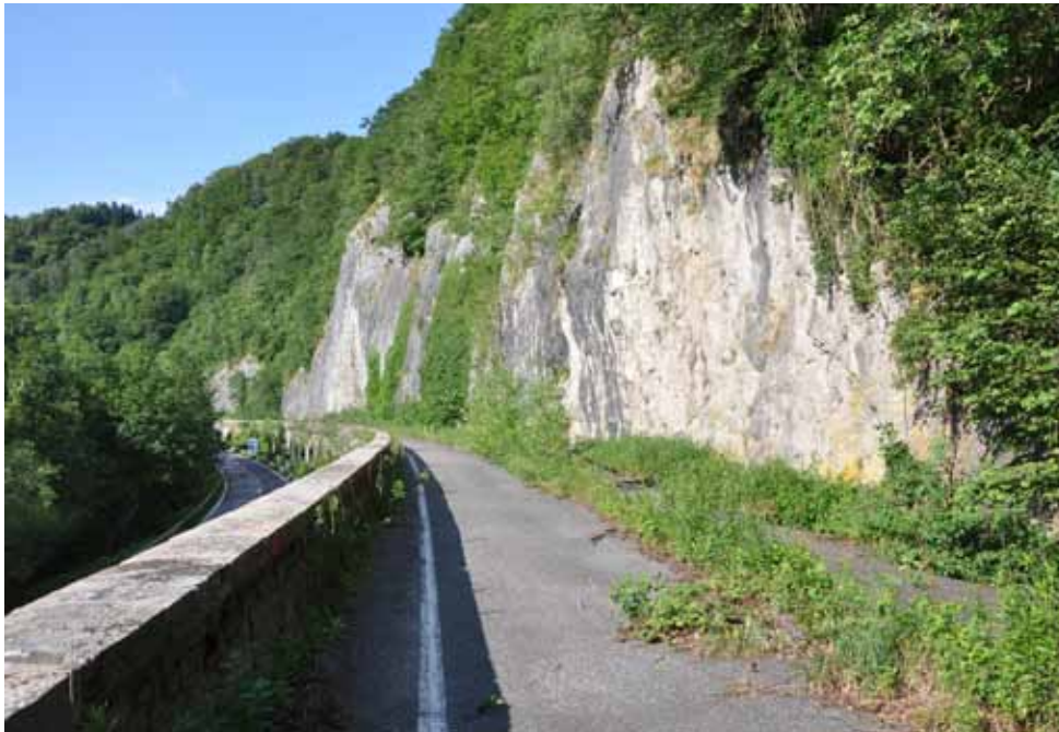
Abb. 134: Bewuchs auf der ehemaligen Fahrbahn, Blickrichtung Nord, gut zu erkennen ist der Bewuchs an der Arbeitsfuge der Asphaltdecke, 07/2010
