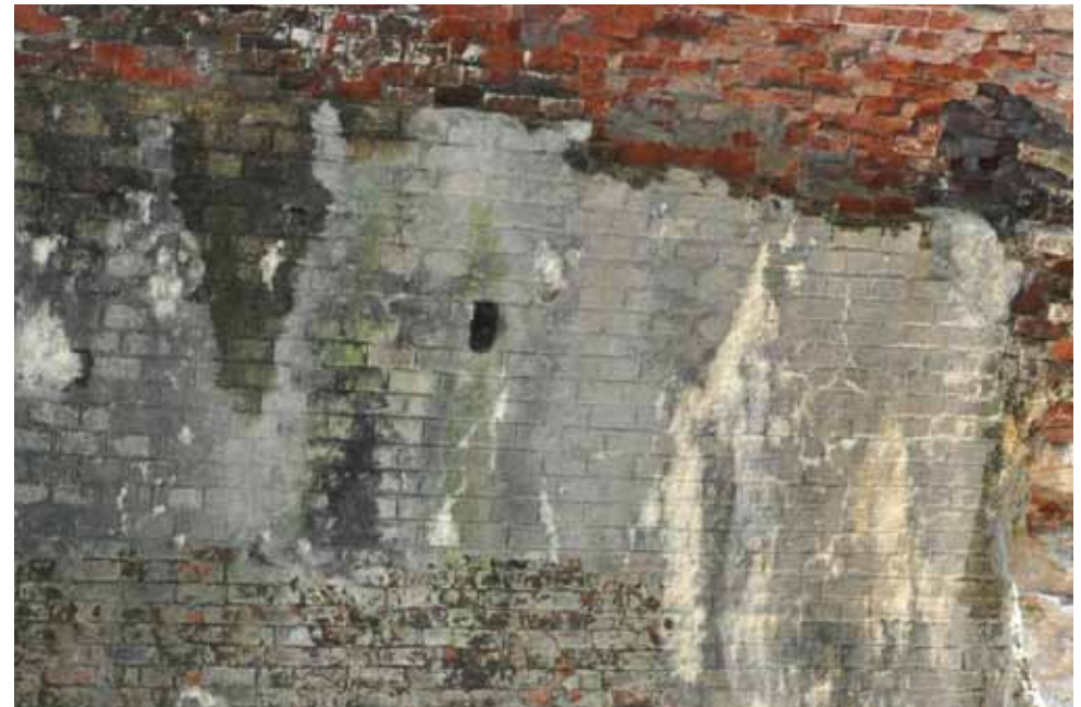
Abb. 99: Betonüberzug im Nordbereich, dem Fugenbild des Ziegelgewölbes angepasst; es darf angenommen werden, dass diese Ausbesserung in den 70er Jahren durchgeführt wurde; 07/2010
