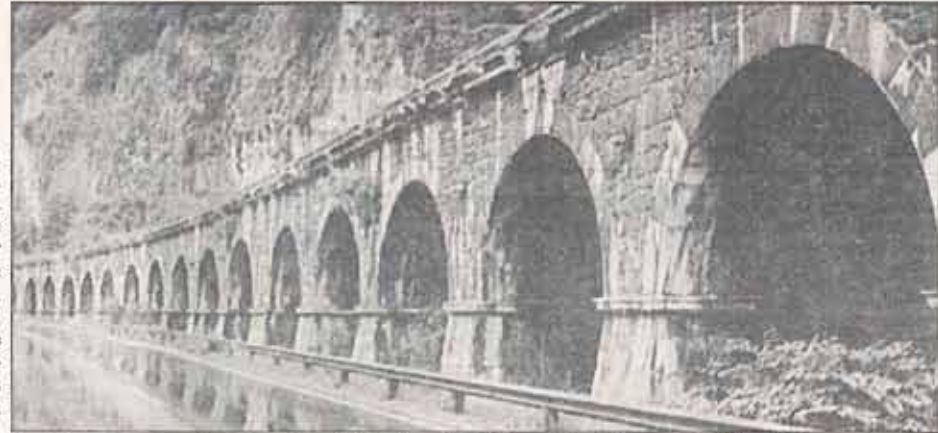
Der älteste Bahnkunstbau Österreichs, die einzigartige Badlwandgalerie ist vom Verfall bedroht (Foto: Schleich)
