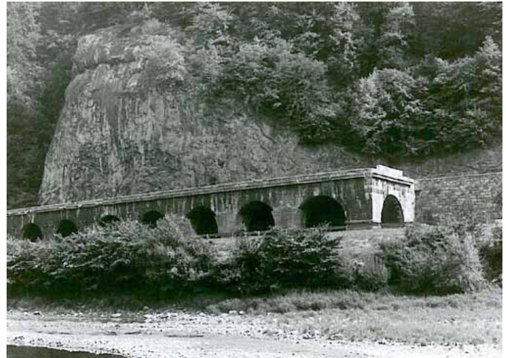
Abb. 49: Südportal kurz nach der Sperre der Galerie, 1978
