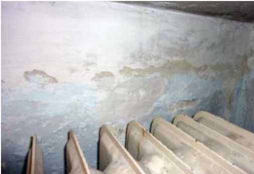
Durchfeuchtung Wand angrenzend Flachdach Werkhof
