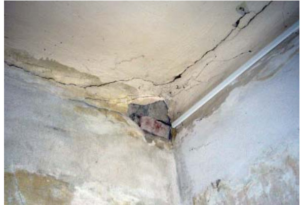
Abplatzungen Wand-/Deckenübergang EG
