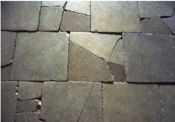
Schadhafter Kunststeinbelag Vorhaus
