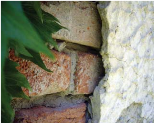
Abplatzunegn Putz Außenwand Osten
