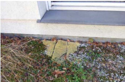
Aufschwimmende Dämmung/unzureichender Hochzug
