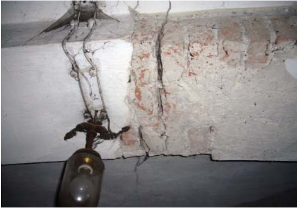
Rissbildung Gewölbe Keller/veraltete Elektroinstallation
