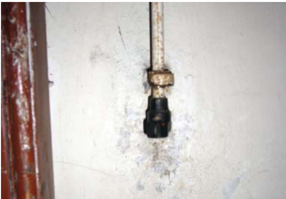
Veraltete Elektroinstallation Keller
