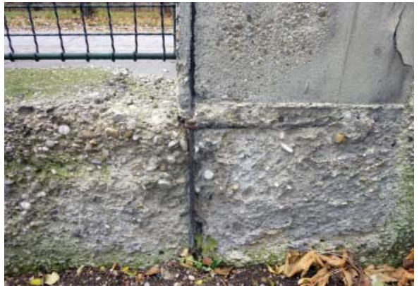
Freiliegender Bewehrungsstahl Einfriedung
