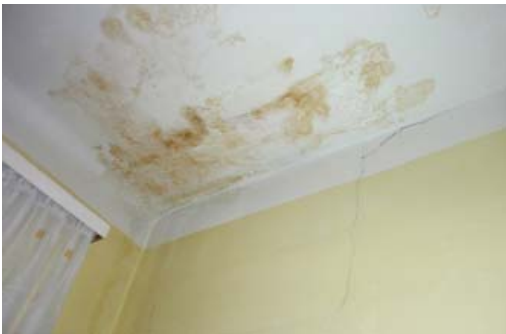
Verfärbung Innenputz/Rissbildung Leichtbauwände
