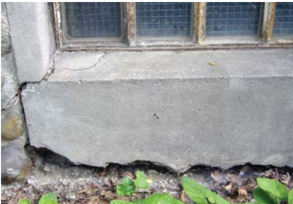
Abplatzungen Sockelabschluss Kellerfenster
