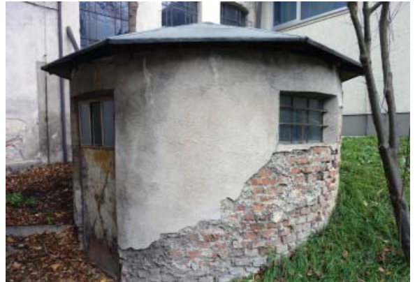
Putzabplatzungen Tiefbrunnen/korrodierte Tür
