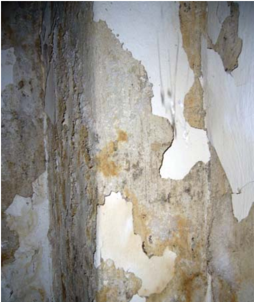
Feuchteschäden Innenwand Norden
