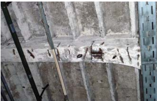
Freiliegende Bewehrung Träger Langbau
