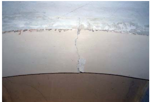
Rissbildung Durchgang Vorhaus EG
