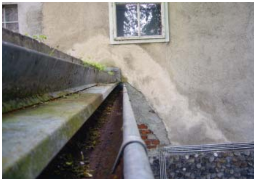
Feuchteschäden Außenwand Norden
