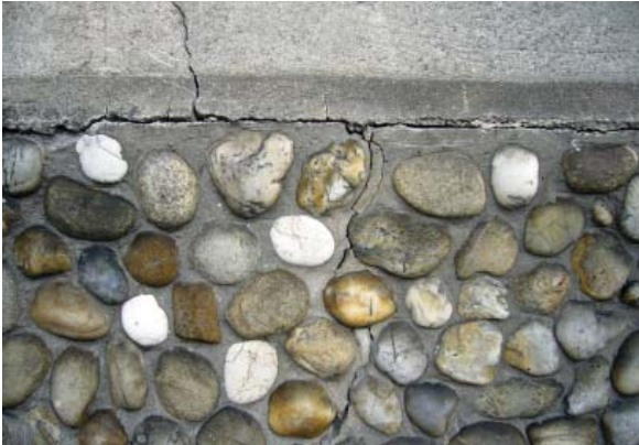
Setzungsrisse Vorsatzschale Flussteinmauerwerk
