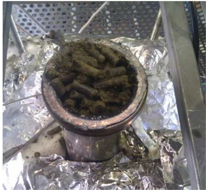
Abbildung 5-24: Verstopftes Fallrohr bei der Brennstoffzufuhr V4
