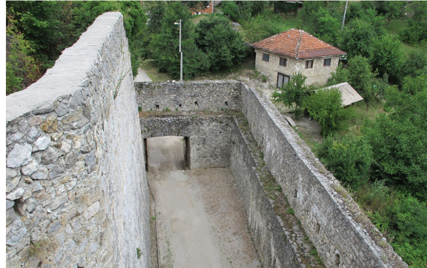
Abb.79 Zwinger (P), Nord Seite, Innenwand Eingang
