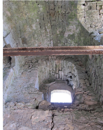
Abb.45 Bastion (E) Süd-Ost Seite, ein Fenster im zweiten Etage- Ansicht von Innen
