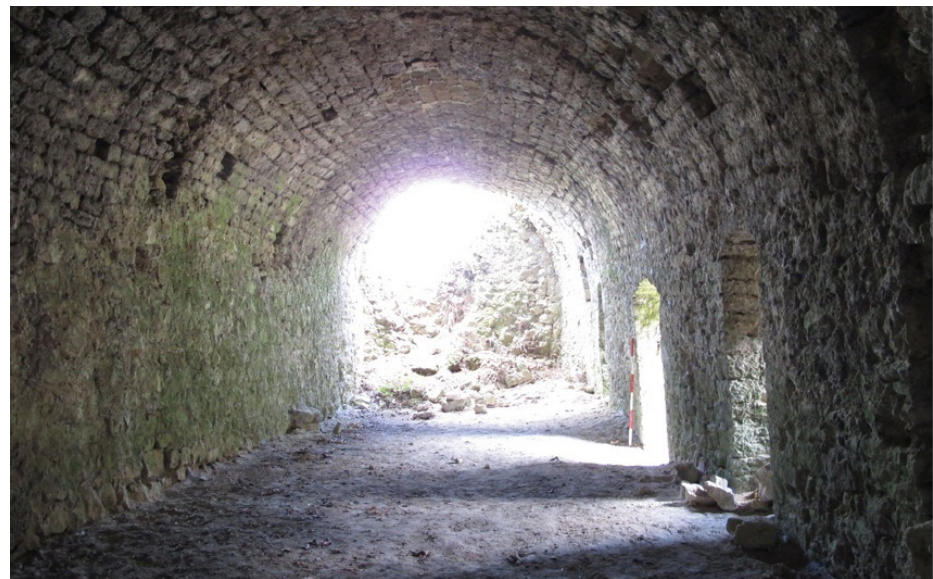
Abb.69 Objekt (B), Ost Seite, Außenmauer - Teilweise zerstört
