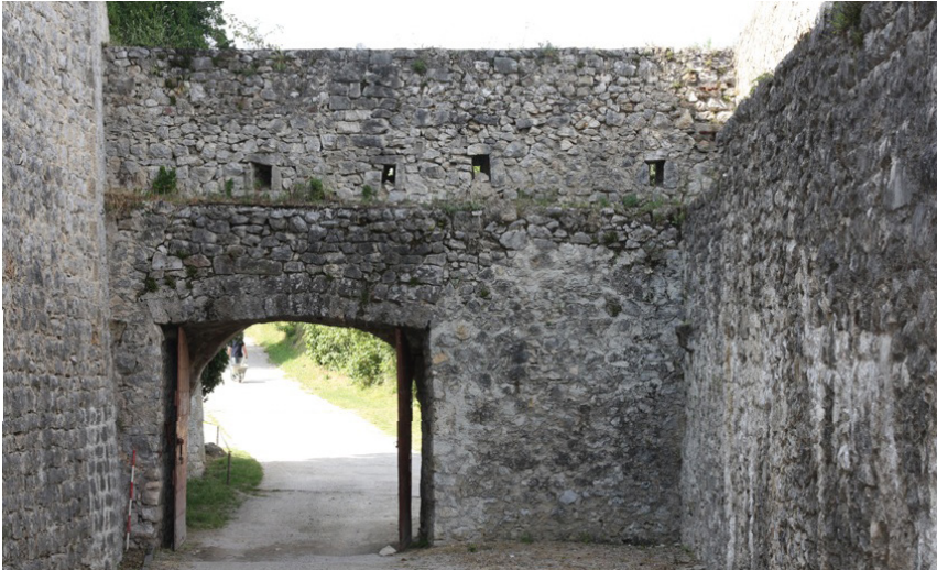
Abb.81 Zwinger (P), Nord Seite, Innenwand Eingang
