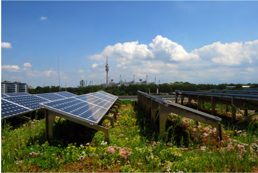
Abb. 29: Solaranlage auf extensivem Gründach
