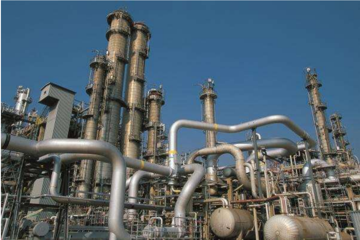
Abbildung 4-25: Ansicht des Trennteils der Ethylenanlage Schwechat mit dem als Zwillingssäule ausgeführten C_3 Splitter [42]
