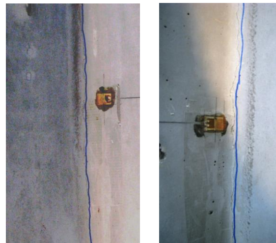
Bild 4-190 Rissbildungen an den linken und rechten Rand
