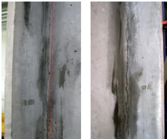
Bild 4-183 Rissbildung an den Stellen 5 und 6
