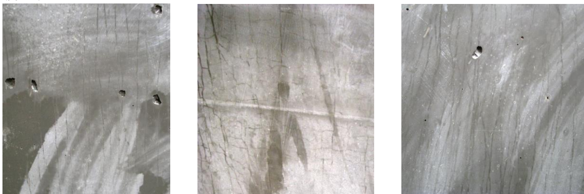
Bild 4-245 Rissbildungen- Stelle 2 (links), Stelle 3 (mitte), Stelle 4 (rechts)
