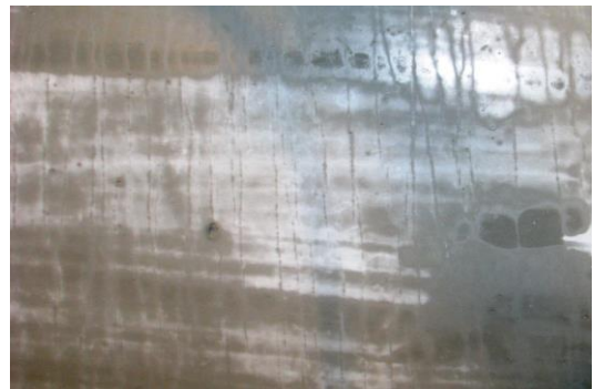
Bild 4-186 Rissbildung im Bereich 4
