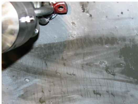
Bild 4-130 Vertikale Rissbildungen in der Scheibemitte- Außenseite
