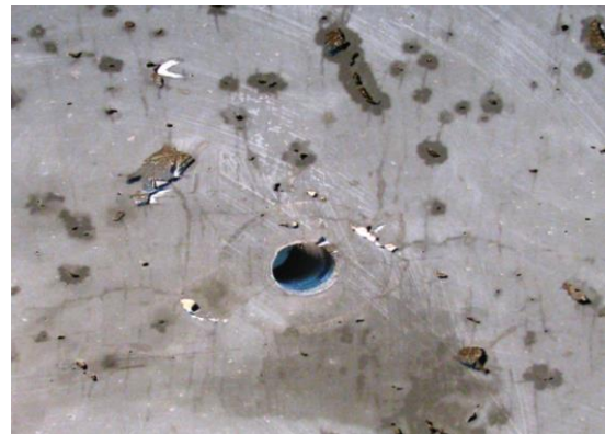
Bild 4-131 Horizontale Rissbildungen in der Scheibemitte -Außenseite
