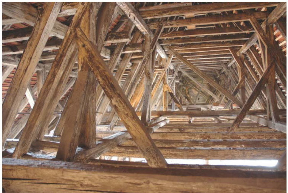
Bild 1.1 Ansicht des zweiten Stockwerks eines Dachwerks des Franziskanerklosters in Graz. Fig. 1.1 View of the second floor in a roof structure of the Franciscan monastery in Graz.
