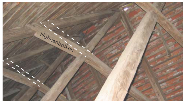
Bild 3.4 Biegebruch der Hahnenbalken infolge ungleichmäßiger Fundamentsetzungen (Schloss Hainfeld).
