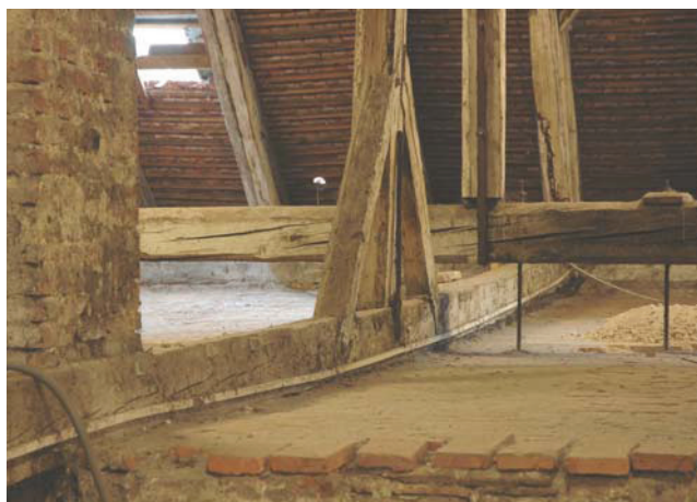
Bild 4A.6 Große Biegeverformung eines Bundtrams. Fig. 4A.6 Big deformation due to bending of a tie-beam.
