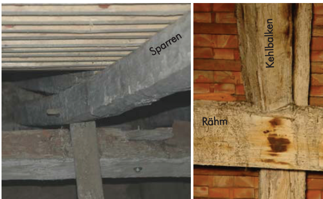
Bild 3.17 Links: Verformung des Sparrens infolge eines asymmetrischen Stuhls, Rechts: Verdrehung eines Kehlbalkens infolge von Schrägfasrigkeit in Kombination mit Schwindvorgängen.
