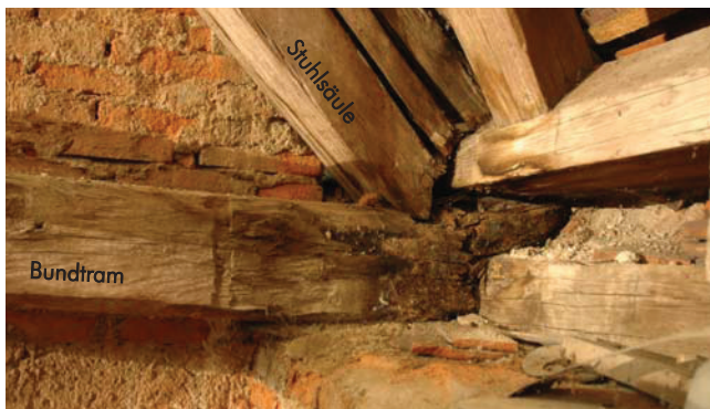
Bild 3.14 Versagter Stuhlsäulenfußpunkt. Fig. 3.14 Failure of a frame column base.
