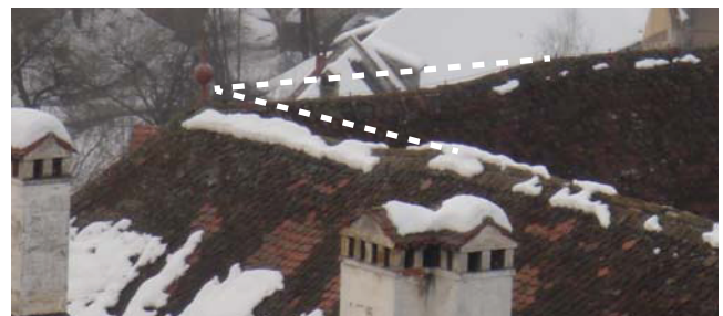
Bild 3.20 „Abgesoffener“ First im Bereich einer Dachverschneidung (vgl. BUCHHÄUSL (2010)).
