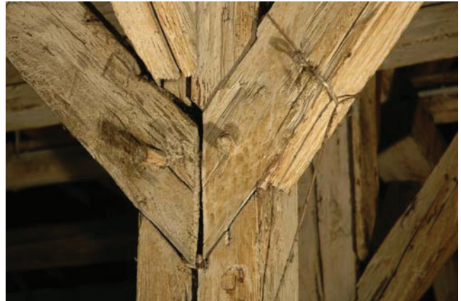
Bild 4B.11 Weißschwänze an einer Stuhlsäule (Palais Herberstein, Graz). Fig. 4B.11 Dovetail lap joint at a post (Palais Herberstein, Graz).
