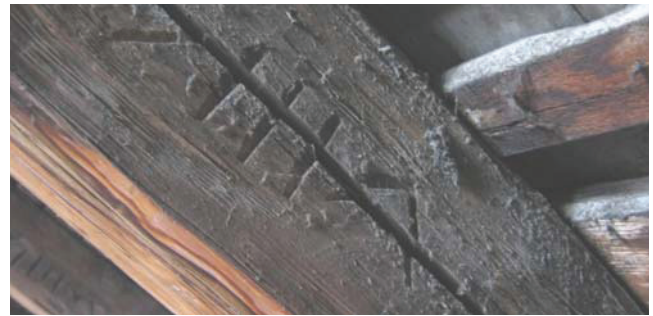
Bild 4A.17 Abbundzeichen an einem Sparren. Fig. 4A.17 Joining marks at a rafter.
