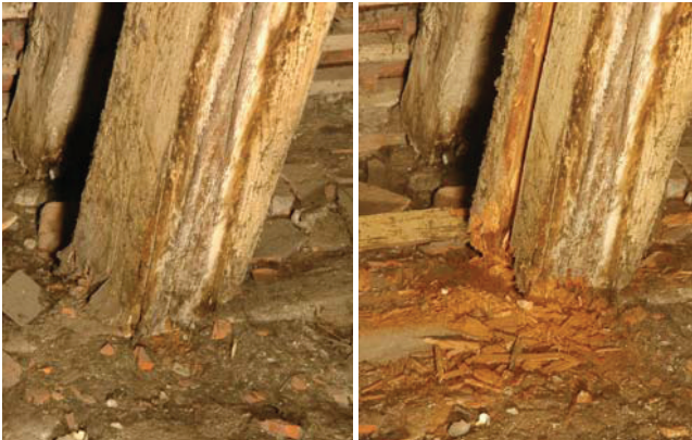
Bild 3.5 Links: Ansicht vor der Klopfprobe, Rechts: danach. Fig. 3.5 Left: view before knocking test, Right: afterwards.
