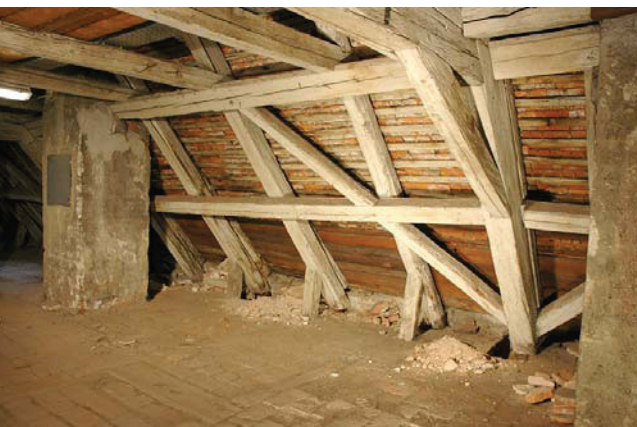
Bild A.62 Dachraum des Südtraktes. Fig. A.62 Attic of the southern wing.
