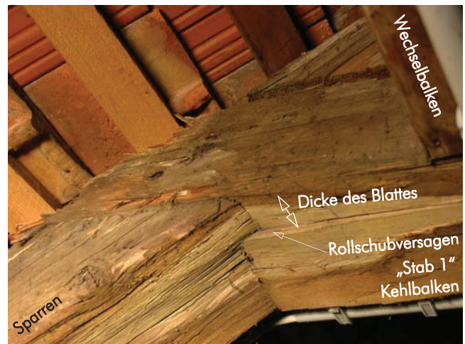
Bild 6.6 Normal- und querkraftbeanspruchte Weißschwanzverbindung mit Rollschubversagen („Stab 1“) im Bereich eines Kaminwechsels.
