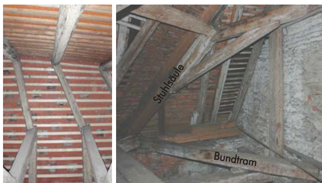
Bild 3.16 Links: Firstbereich ohne Aussteifung in Firstrichtung, Rechts: Kehlbalkendach mit einfach liegendem Stuhl (mit nicht fachgerechter Instandsetzung).
