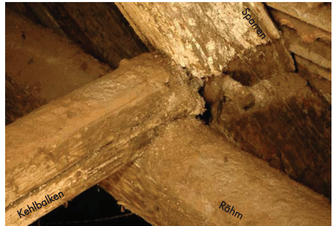
Bild 3.19 Verschmutzung der Bauhölzer.
