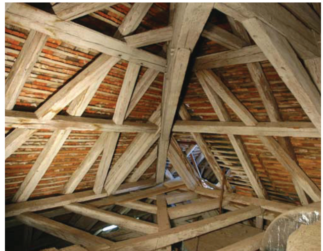
Bild 4A.2 Kehlbalkendach mit liegenden Stühlen, Aufnahme aus dem zweiten Stockwerk im Walmbereich (Alte Universität Graz).
