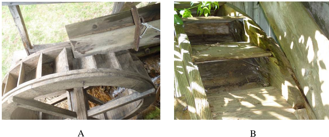
Abb. 182 Gerade eingesetzte Schaufeln (A) bei der Mühle vlg. Zipfweber (EM 19) und gebrochene Schaufeln (B) bei der Mühle vlg. Stöckelbauer (EM 01),
