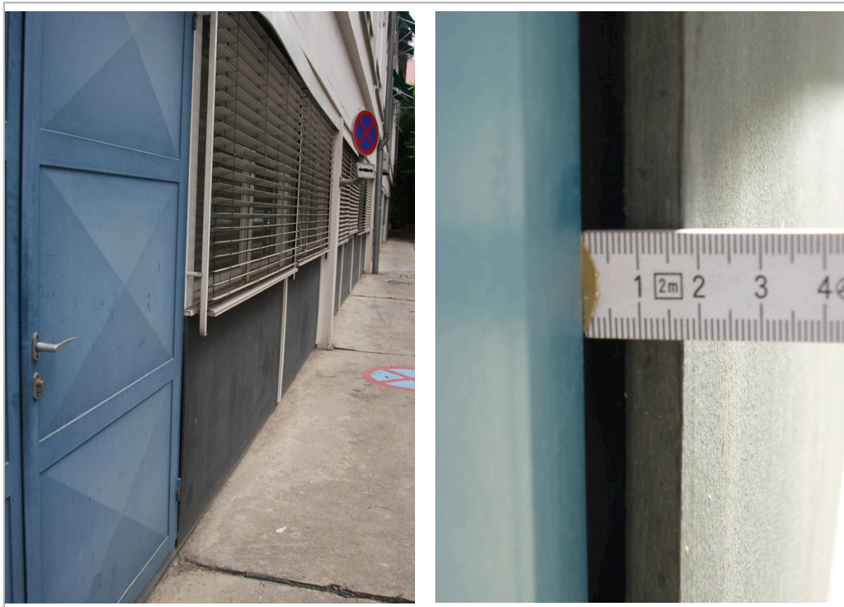
Abbildung 6-56: Schadhafte Faserzementplatten im Erdgeschoß (hofseitig) der Stremayrgasse
