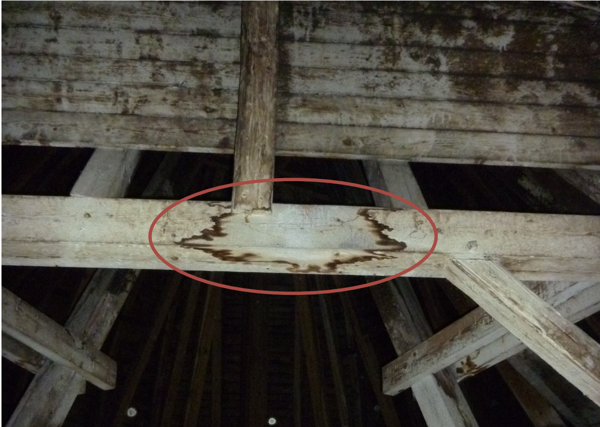
Abbildung 6-55: Auswirkungen von Wassereintritt im Dachraum
