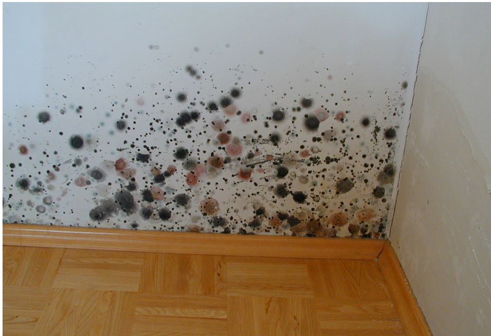
Abbildung 6-34: Beispiel für Schimmelbildung an einer Außenwand mit Innendämmung (Foto: Gamerith)
