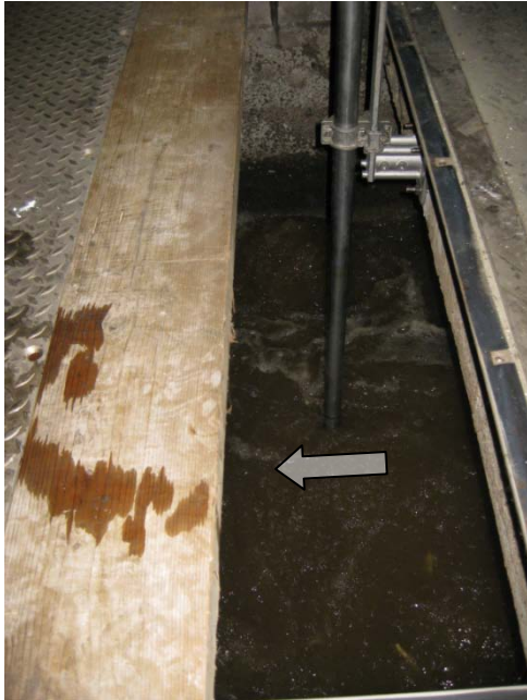
Abbildung 4.18: Trübungssonde im eingebauten Zustand nach dem Schotterfang
