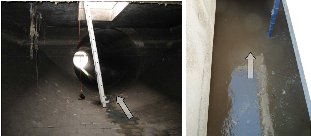
Abbildung 4.21: Überlaufkammer und -kanal (links) und Trübungssonde in der durchflossenen Überlaufkammer zu den Mischwasserüberlaufbecken (rechts)
