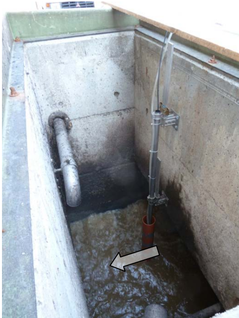
Abbildung 4.15: Trübungssonde im eingebauten Zustand im Zulauf der Kläranlage
