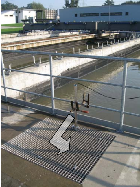
Abbildung 4.12: Trübungssonde im eingebauten Zustand im Ablauf der Vorklärbecken (Foto: Günter Gruber)
