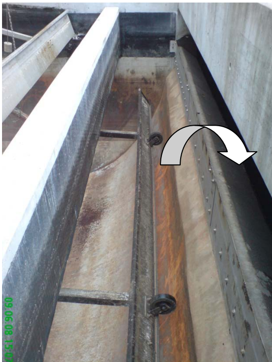
Abbildung 4.3: Überlaufwehr und Tauchwand im Ausströmbereich (Foto: Günter Gruber)
