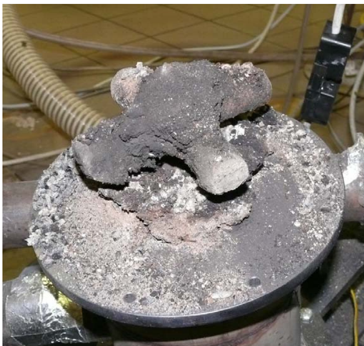
Abbildung 150: Blick auf das Primärluftkreuz
