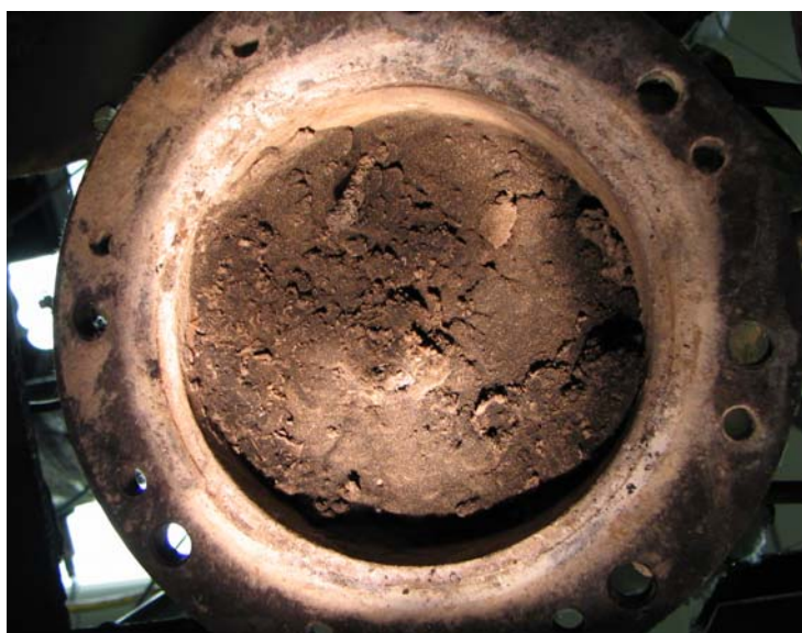
Abbildung 80: Blick in das Vergaserrohr der modifizierten Versuchsanlage 1 von unten Erläuterungen: Testlauf vom 18.10.2007; Brennstoff: Weichholzpellets
