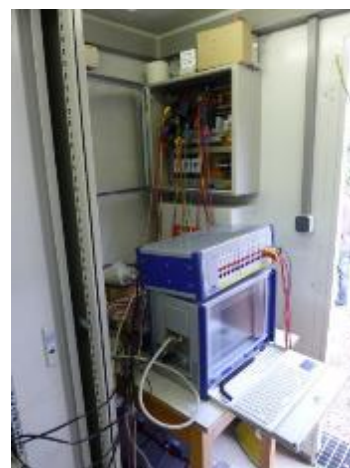
Abbildung 89: Messaufbau in der Funkrepeaterstation Plabutsch
