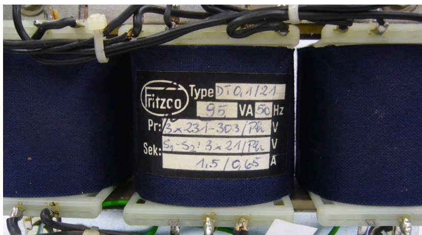
Abbildung 4.4: Ansicht der Spulenkörper und des Typenschildes des untersuchten Transformators
