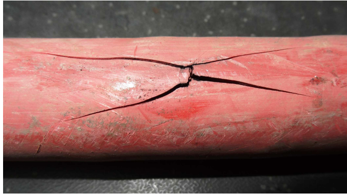
Abbildung 6.6: Aufgeplatzter Mantel an der Probe 1-20-25-B2
