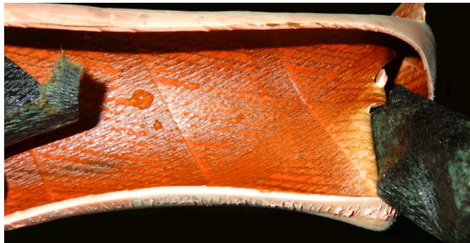
Abbildung 6.7: Wassertropfen zwischen Mantel und Isolierung
