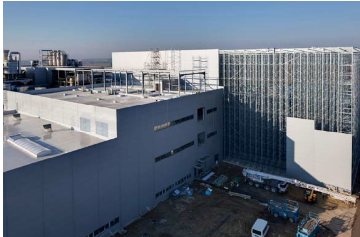
Abbildung 3.3: Bauzustand eines Industriegebäudes mit Sandwichwandelementen [21]
