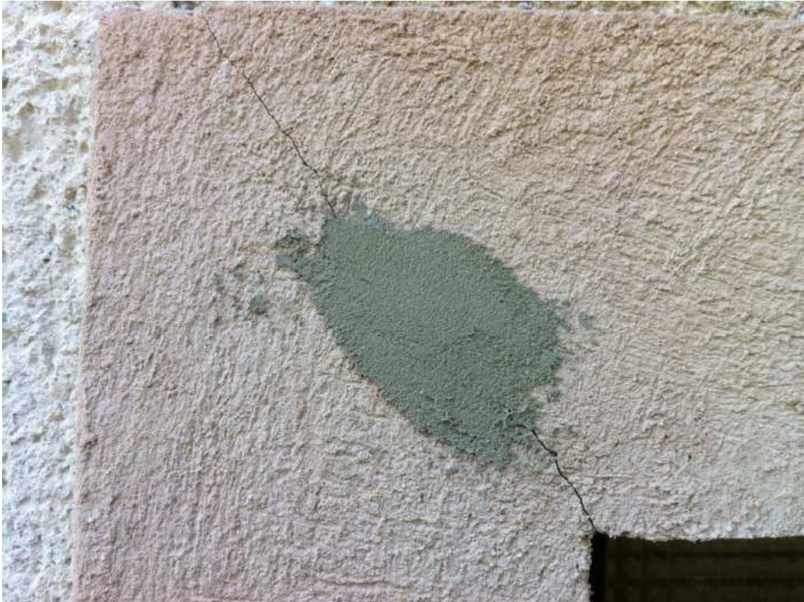
Abbildung 6-15 – Rissbildung am Gebäude - Verplombung mit Zement 253
