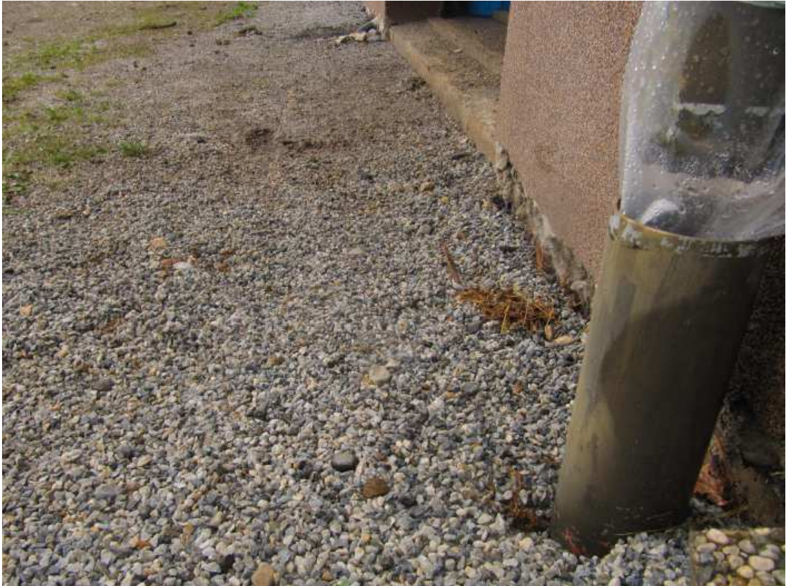
Abbildung 6-13 – Zugriffs im Gründungselement des Wohngebäudes an der Talseite 251
