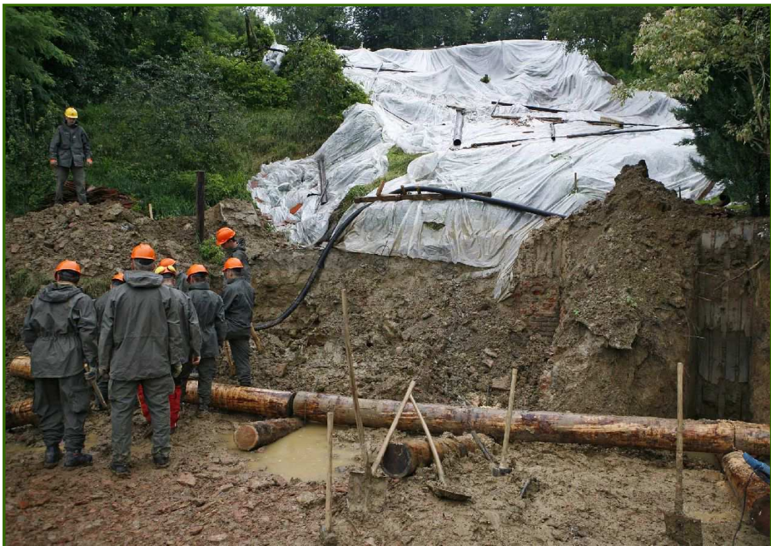
Abbildung 2-15 – Abdecken des abgerutschten Hanges als Sofortmaßnahme 79
