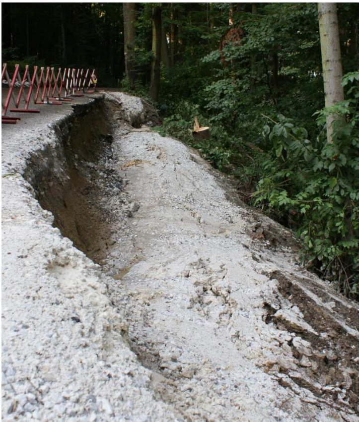
Abbildung 4-9 – Schäden an der Gnaninger Straße nach einem Erdbeben
