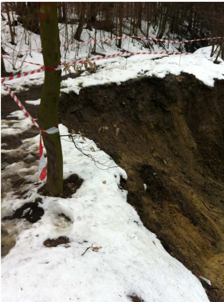
Abbildung 4-8 – Beschädigung einer Forststraße und eines Privatgrundstücks
