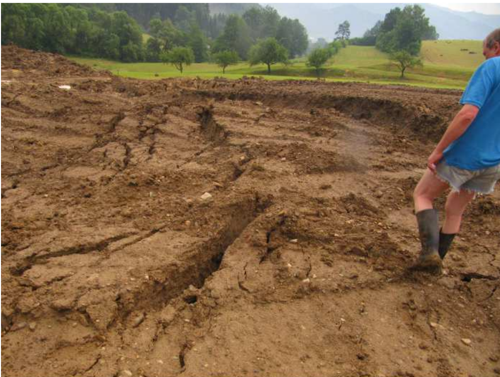
Abbildung 6-17 – Zugrisse im Mittelteil der Hangrutschung 256
