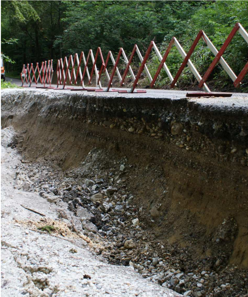
Abbildung 4-10 – Versatz nach der Rutschung an der Gnaninger Straße
