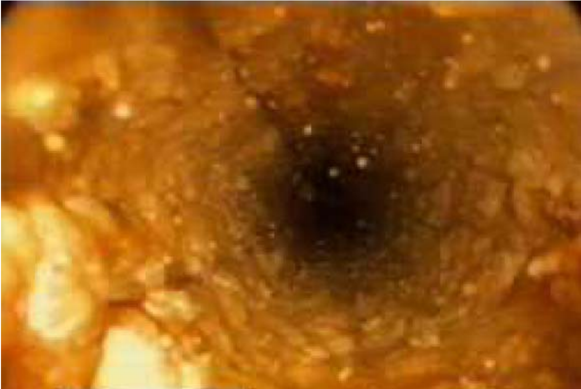
Abbildung 28: Verockerung in einem Schluckbrunnen (Personenkreis Geothermie der AD-HOC-Arbeitsgruppe Geologie, 2011, S. 19)
