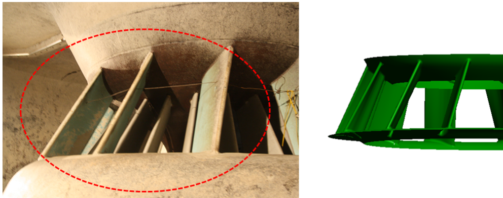
Abbildung 2.6.: Bereich der ersten Stützschaufeln; Foto (links), CAD-Modell (rechts).
