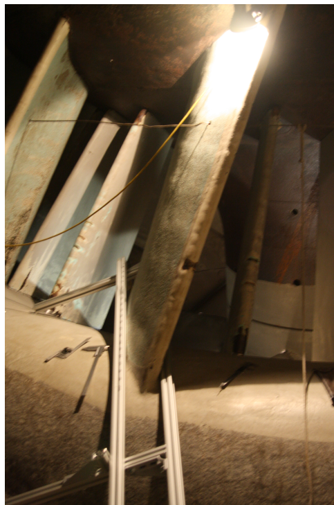
Abbildung 2.5.: Messvorrichtung an Stützschaufel Nr. 9, Maschine 3.
