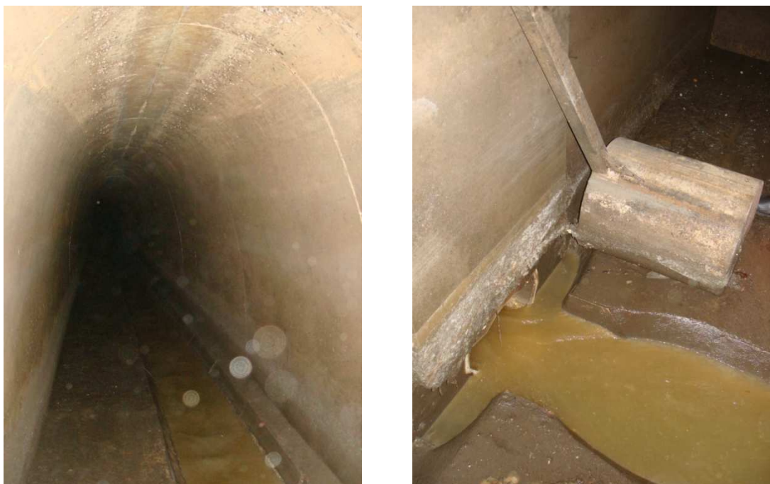
Abb. 2-2: Innenansicht und Drosseleinlauf des Stauraumkanals (Veit, 2009)
