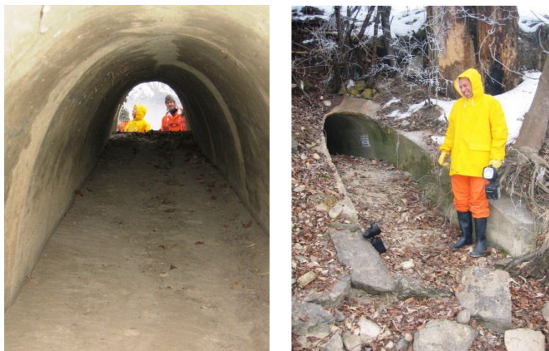
Abbildung 2-39: Ende des Entlastungskanals des „L01“ mit starken Verlandungen im Auslaufbereich, welche von den Sommer-Hochwässern des Jahres 2005 resultierten (Kainz und Gruber, 2006)
