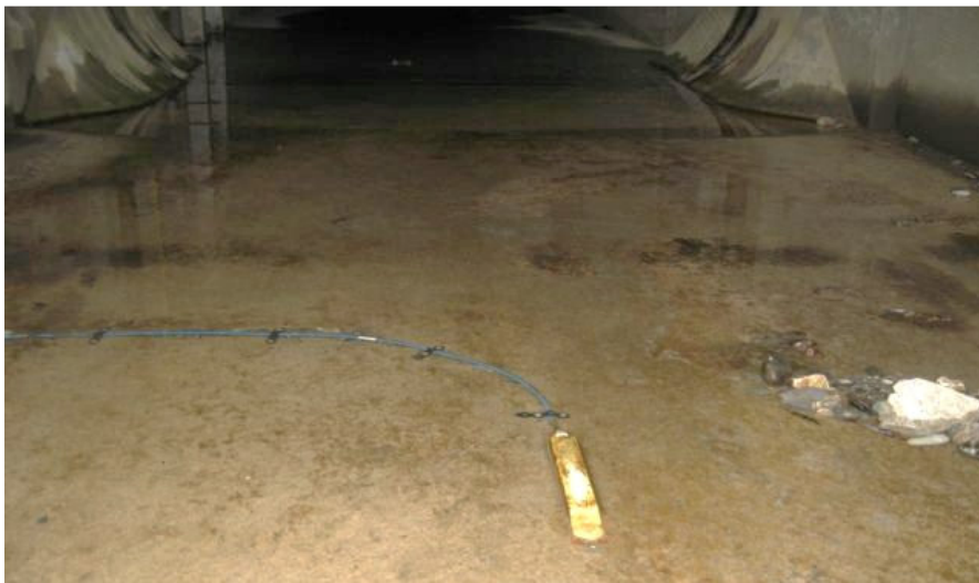
Abbildung 3-5: Installationsort des mobilen Durchflussmesssystems PCM-Pro an der Sohle des ZSK am Wehrbauwerk KS2
