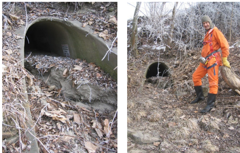
Abbildung 2-40: Extrem hohe Verlandungen (ca. 2/3 der Profilhöhe) am Ende des Entlastungskanals des Entlastungsbauwerkes „L02“ (Kainz und Gruber, 2006)
