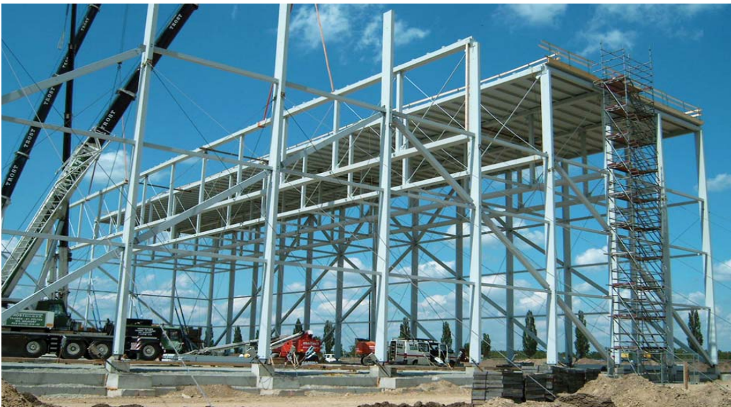
Abb. 2.1 Ansicht des Fachwerkes (oben), Axonometrie der geplanten Halle (Mitte links), Zugstaban- schluss (Mitte rechts), Montage der Fachwerke (unten) [34]
