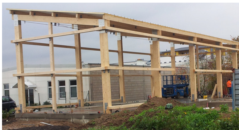
Abb. 1.4 Stützen als Hallentragwerk mit Hilfskonstruktionen an der Außenseite zur Verringerung der Knicklänge und als Unterkonstruktion für die Fassade [21]
