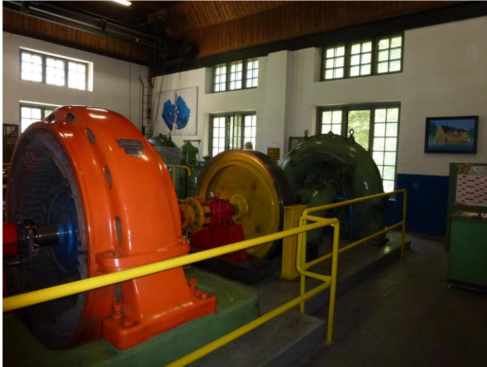
Abbildung 2.26: Eine der beiden Francis-Zwillingsturbinen im Krafthaus des KW II
