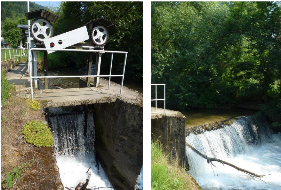
Abbildung 4.31: Wehranlage KW Kettenwerk Brückl: links: Grundablass, rechts: Festes Wehr
