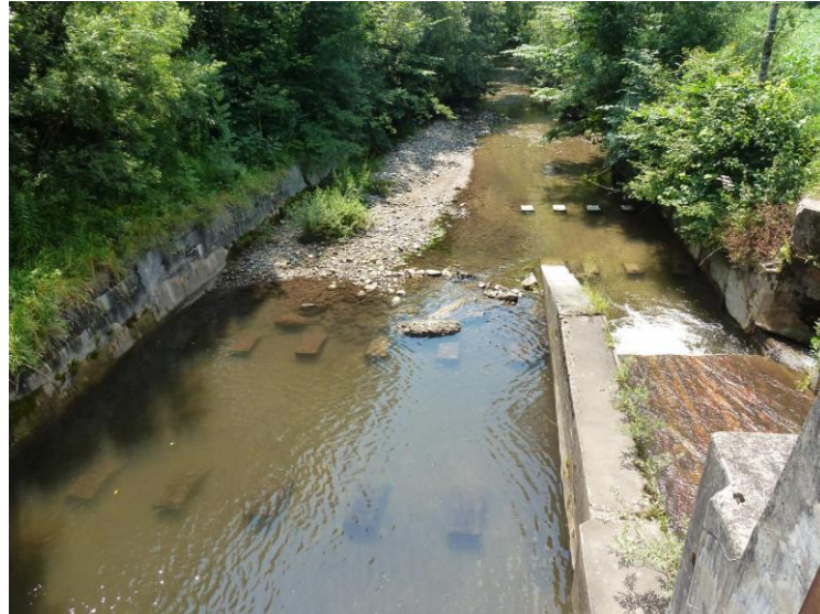
Abbildung 2.31: Wehranlage KW III: Restwasserstrecke und Tosbecken mit Störkörpern
