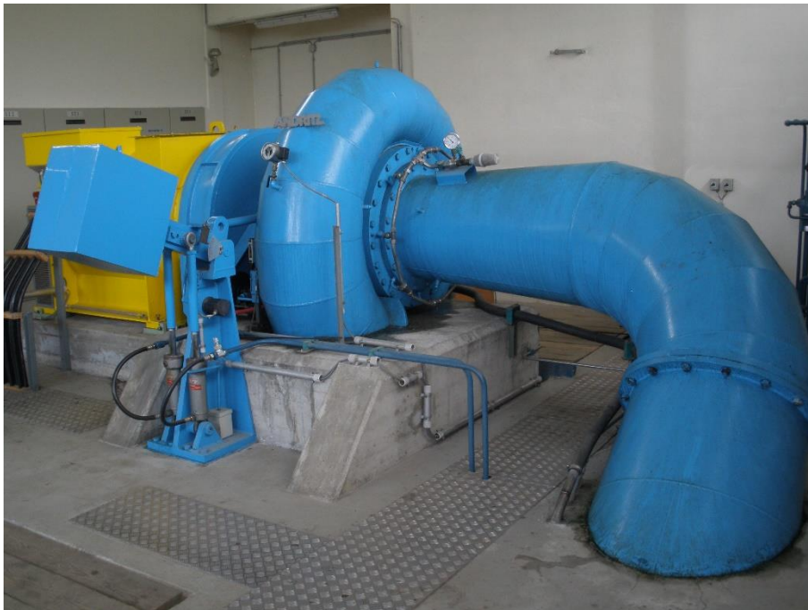
Abbildung 2.15: Maschinenraum KW IV – im Bild eine der beiden Francis Spiralturbinen
