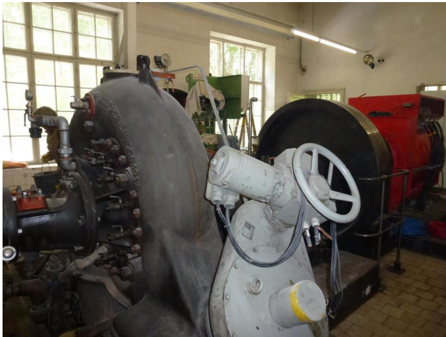
Abbildung 2.5: Maschinenhalle KW Hüttenberg
