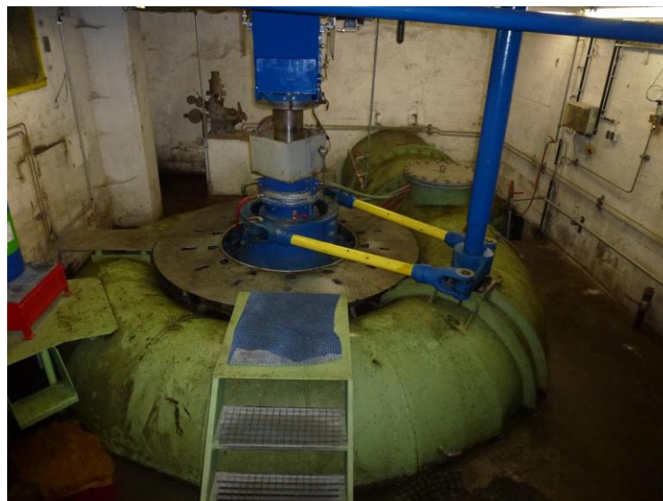
Abbildung 2.30: Kaplanmaschine im Kavernenkrafthaus III
