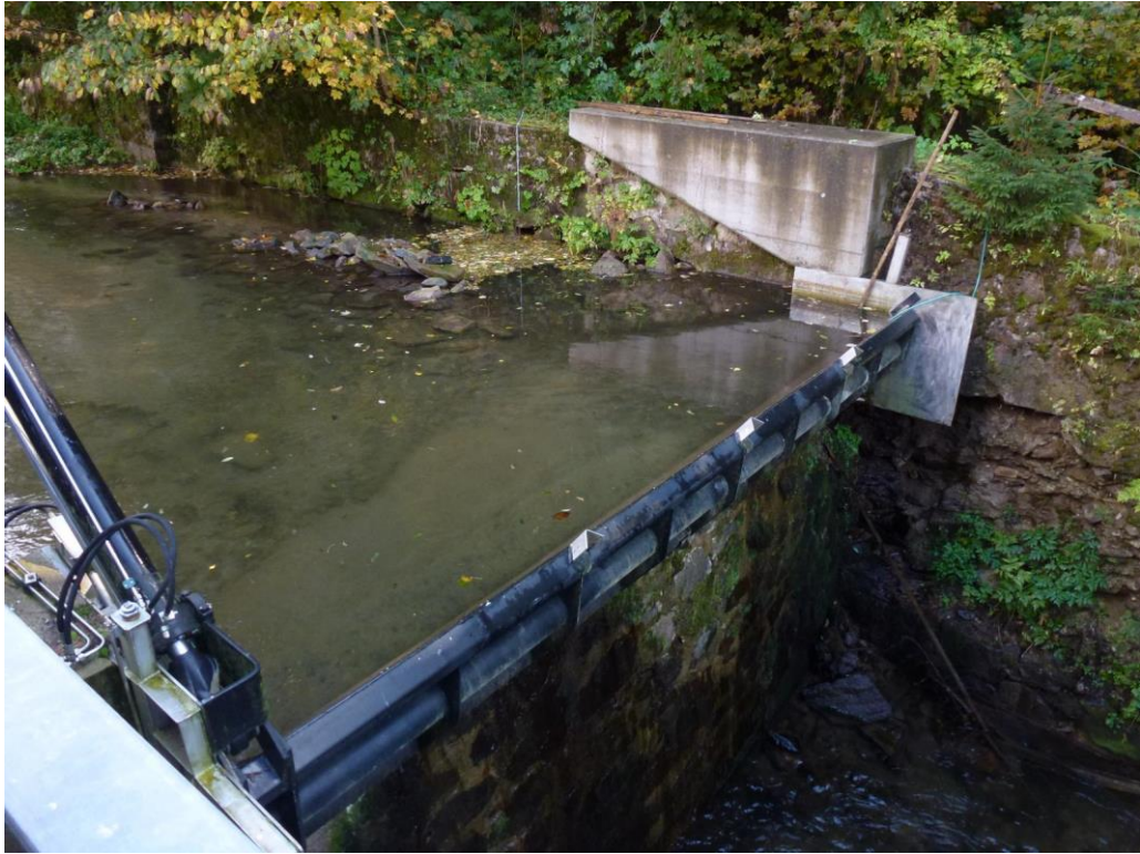
Abbildung 2.13: Wehranlage KW Neugebauer
