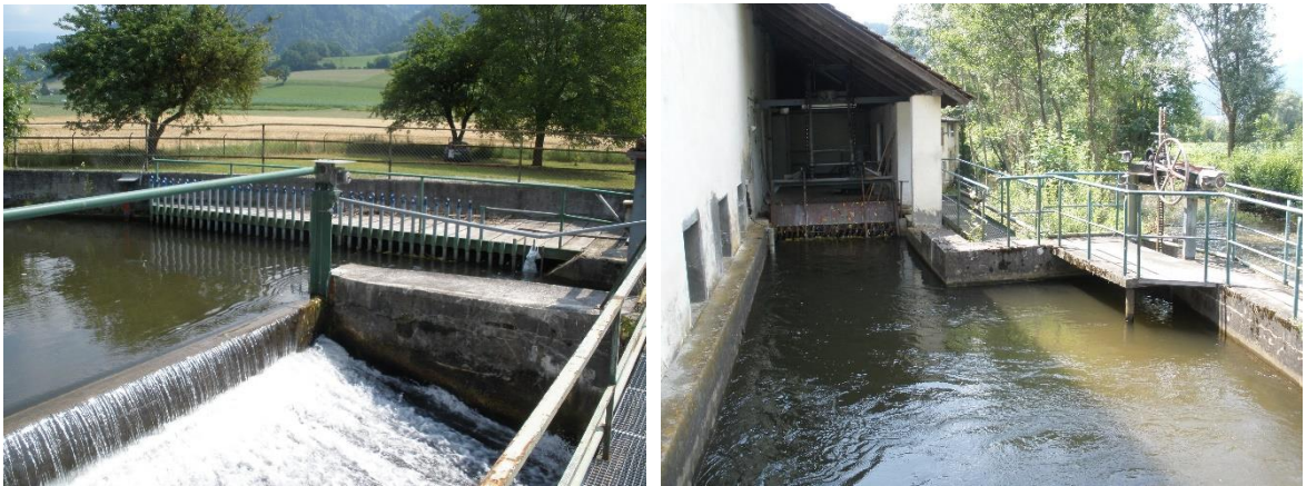
Abbildung 2.36: Grobrechen und Turbineneinlauf
