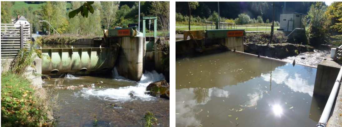
Abbildung 2.8: Wehrklappe KW Moser unterwasser- bzw. oberwasserseitig
