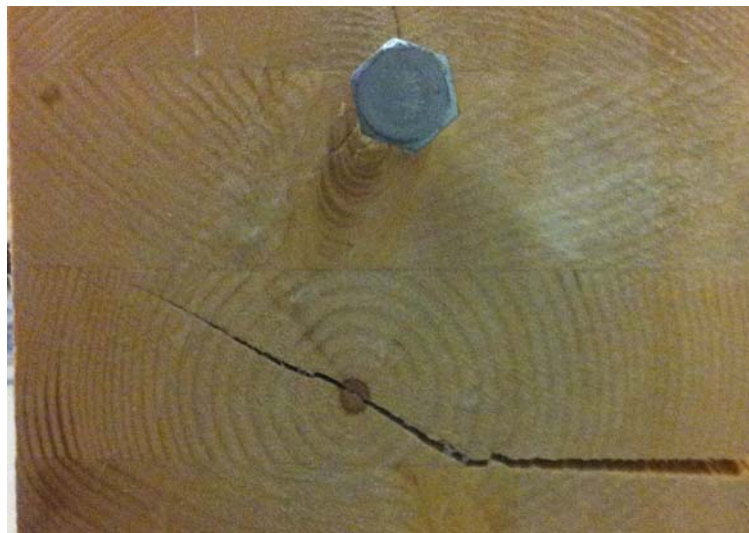
Abb. 1.27 Rissbildung Prüfkörper Nr. 6 nach 70 Tagen
